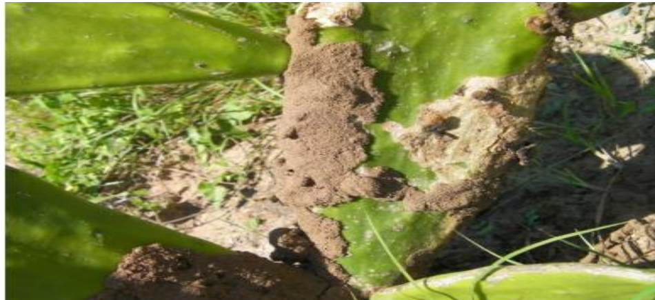
Figura No. 15 Causa de Termitas
