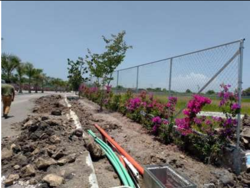
Imagen 34. Tendido de instalaciones subterráneas en Lomas de Tehuicil. Imagen del autor, obtenida el 24 de julio de 2021.
