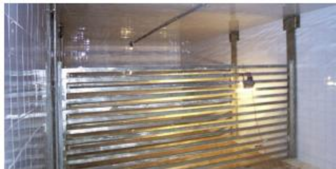
Figura 3.2. Rejillas en tanque de masa líquida sintonizada (tomada de Lago et al., 2019)
