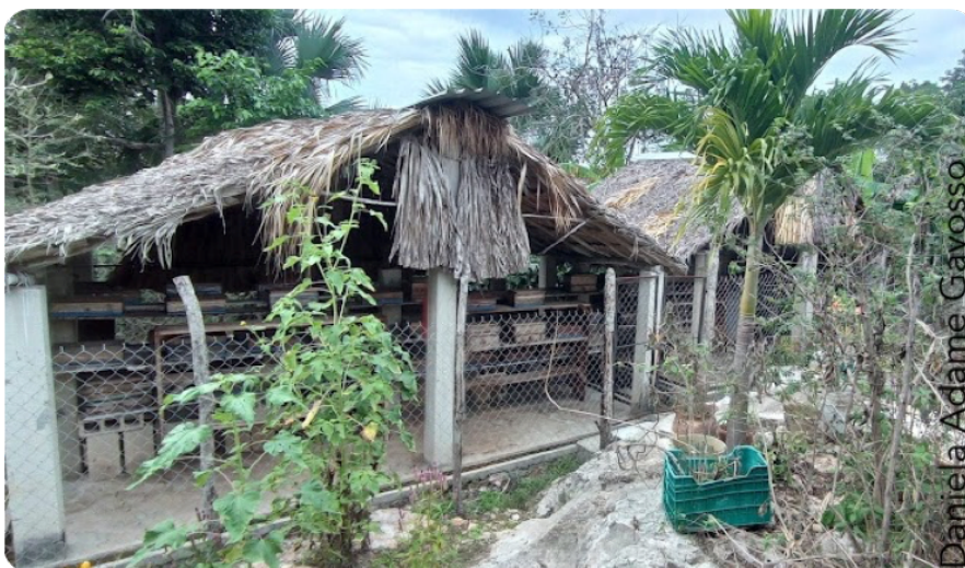
Fig. 17 Meliponario del grupo Flor de mayo, Maní, Yucatán. La estructura de soporte está constituida por columnas de cemento, rodeadas por malla ciclónica, el techo está elaborado con palma y termina con una cumbre de lámina de zinc. Cuenta con canaleta perimetral con agua, las colmenas están dispuestas sobre anaqueles de madera y algunas sobre blocks.
