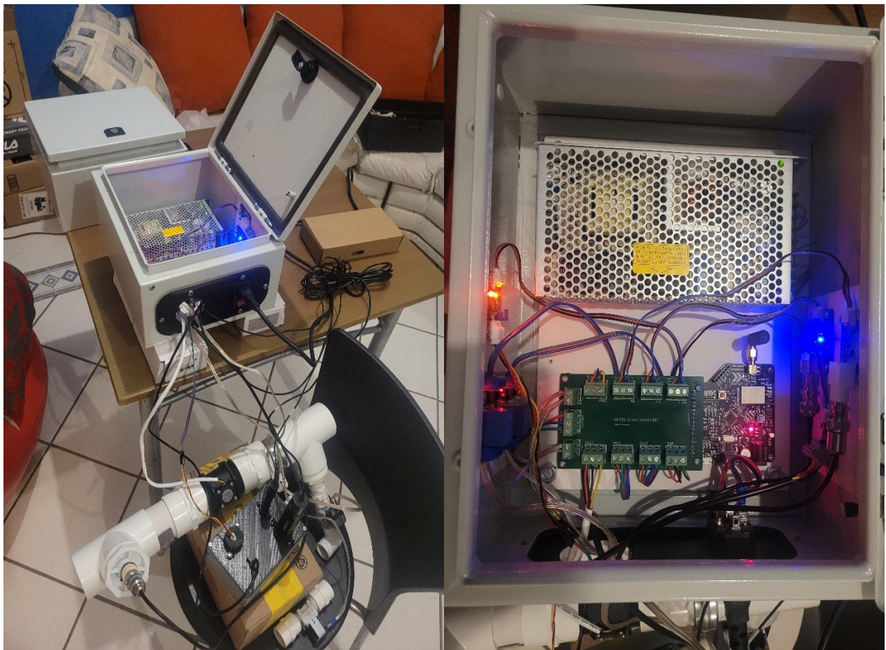
Ilustración 91 - Evidencia prueba de funcionamiento integral
