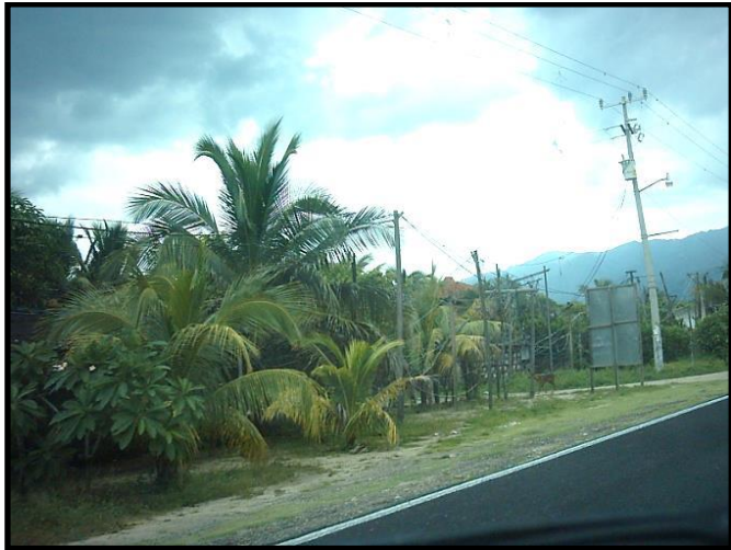
Figura 114.-Tomas informales de electricidad.
