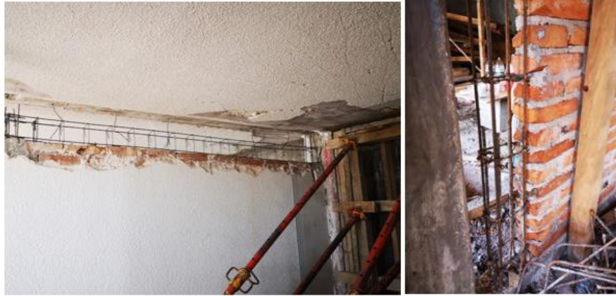
Figura 18. Adición de elementos de confinamiento en muros de mampostería. (Archivo fotográfico proyecto ConTex, 2018).
