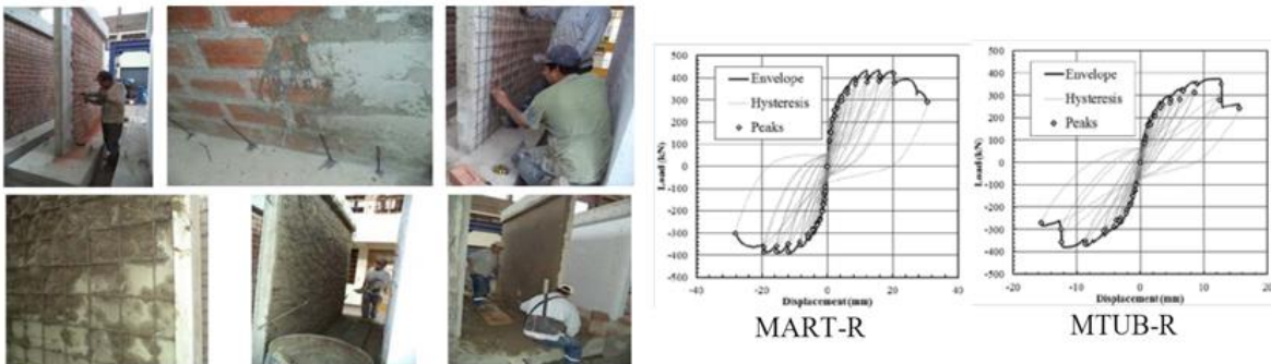
Figura 29. Aplicación de la técnica de rehabilitación en los muros MTUB y MART y curvas de comportamiento histerético (Díaz, et al., 2017).
