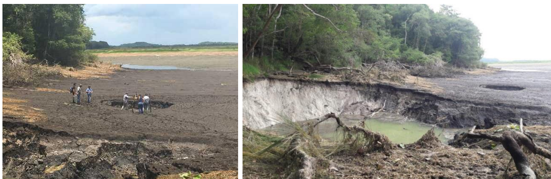
Figura 27. Colapsos en la Laguna de Chakanbacán (Wright, 2018).
