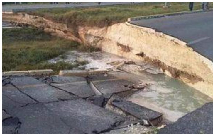
Figura 26. Colapsos frente al hotel Iberostar, Cancún (Milenio, 2015)
