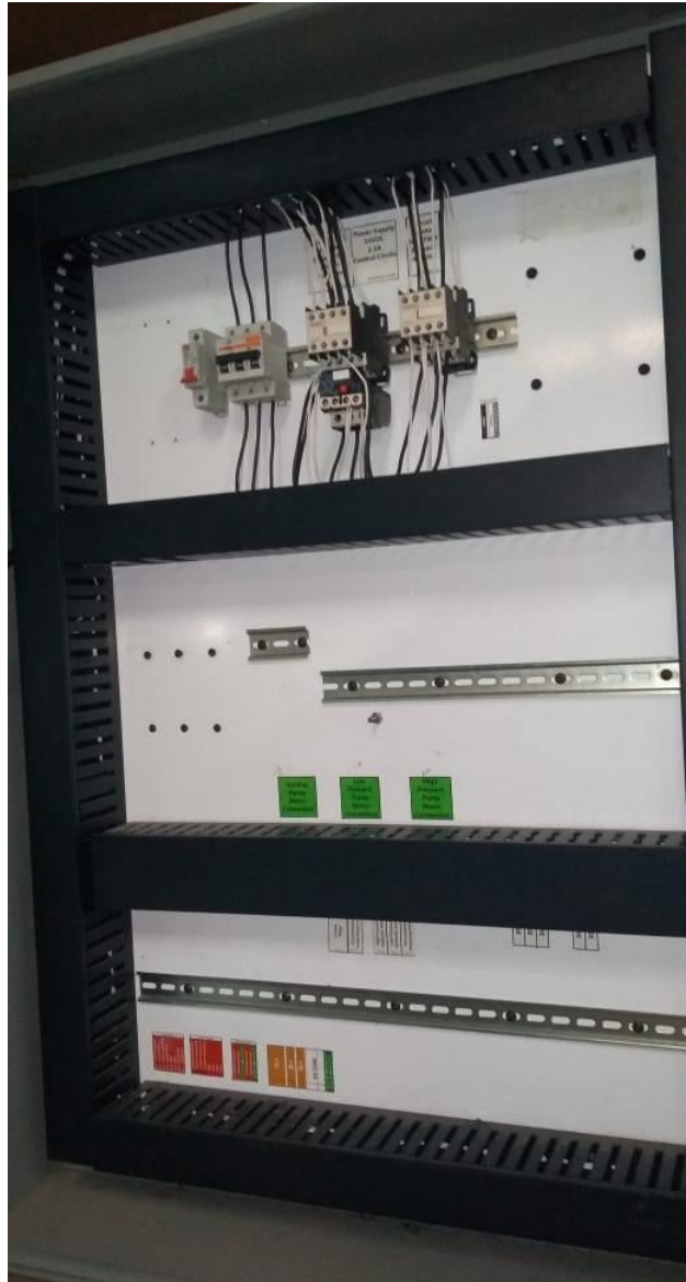
Figura 7.18: Conexiones de los elementos de control internos dentro del tablero, 1 protección termomagnética, 1 Relés térmico, 2contactores ,2contactores auxiliares.
