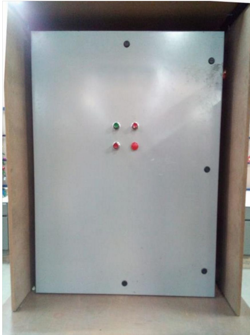
Figura 7.16: Tablero de control real instalado en el LIME-3 de la FES-Cuautitlán. [3]
