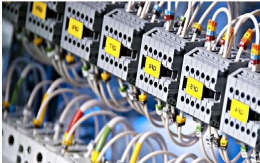
Figura 3.18: Conjunto de contactores de un panel de control eléctrico. [4]
