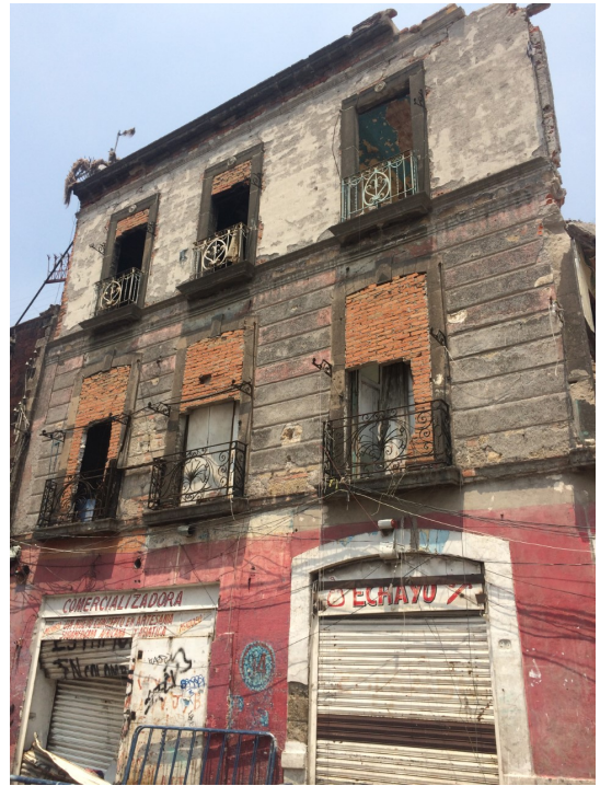
Fig. 3 Deterioro, calle Centro CDMX.
