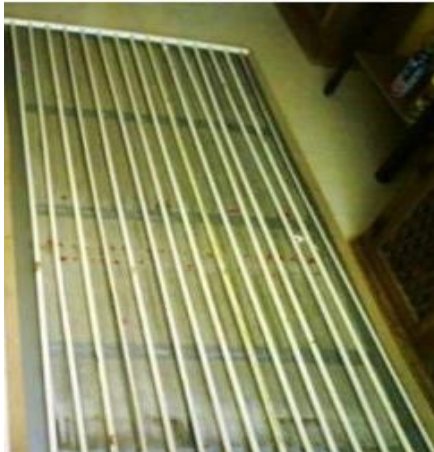
Armando del panel con tubos de cpvc, tomado del Manual de Manual de Ecotecnias Prácticas sustentables.
