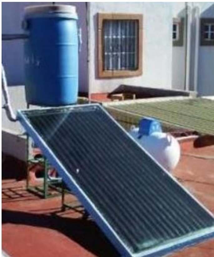
19 Calentador solar de CPVC diseñado por el Ing. Noé Tapia. Sacado de Manual de Ecotecnias y Prácticas sustentables.
