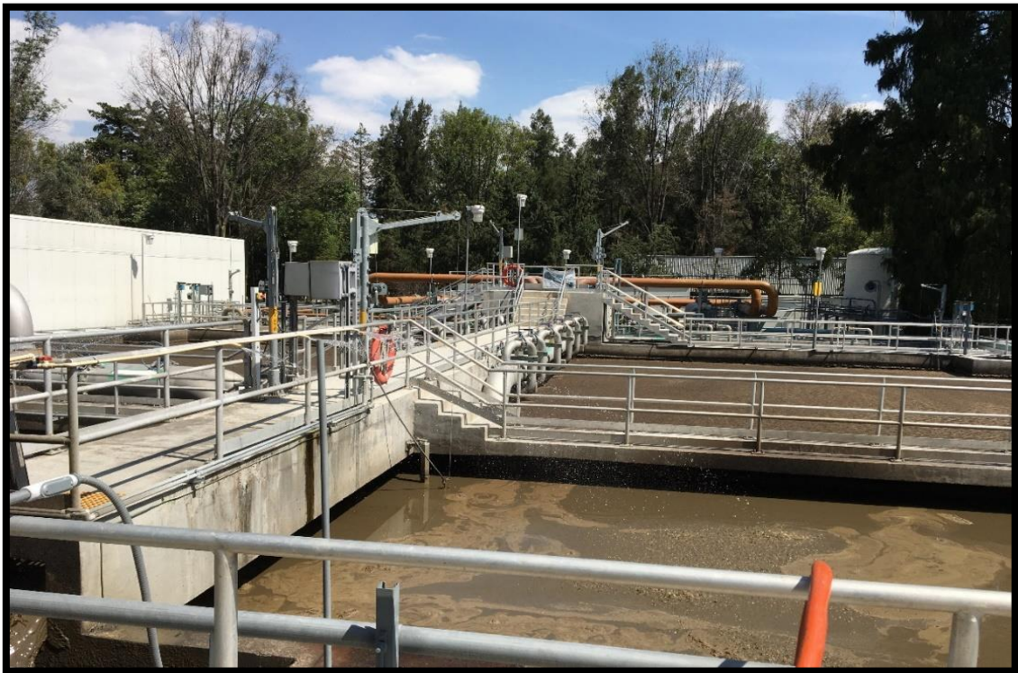
Figura 4.18. Vista de la PTAR Chapultepec.
