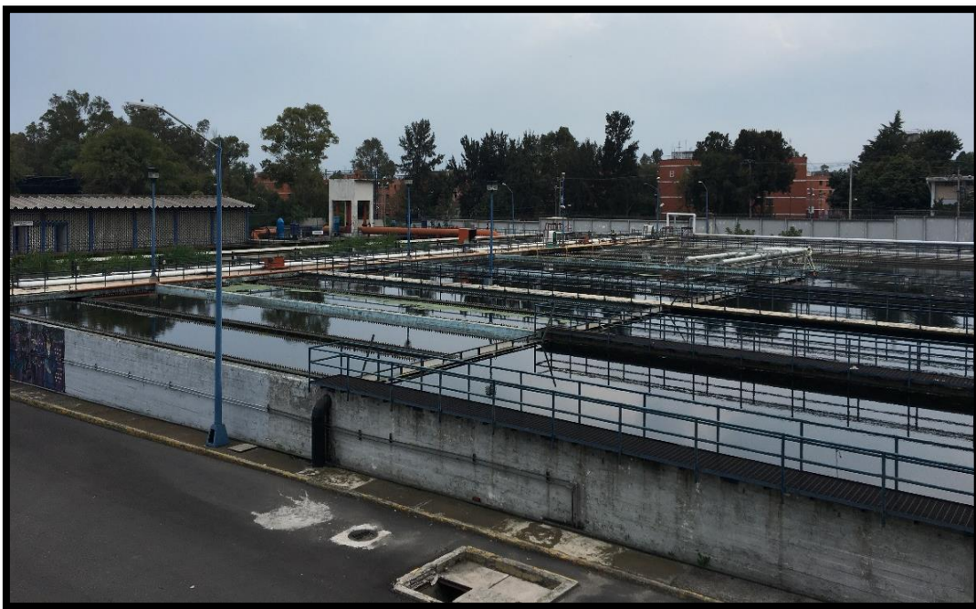
Figura 4.17. Vista de la PTAR Cerro de la Estrella (sedimentadores secundarios).
