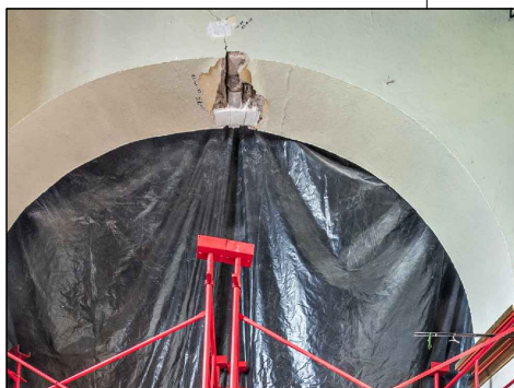
FOTO-02 VISTA DE ARCOS FAJON DEL PRESBITERIO QUE PRESENTA GRIETA CON PÉRDIDA DE APLANADO Y APLANADO SUELTO EN SU TRAYECTORIA.
