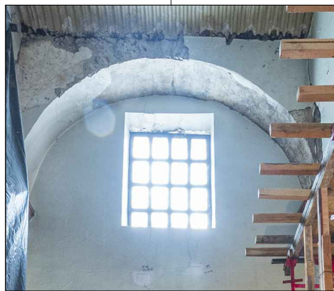
FOTO-01 VISTA DE PÉRDIDA DE APLANADO EN EL ARCO FORMERO.
