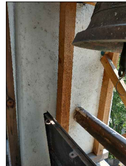
FOTO-06 VISTA DE FISURAS EN PIERNAS DEL PRIMER CUERPO DE LA TORRE CAMPANARIO.
