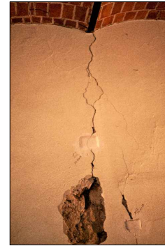
FOTO-05 VISTA DE GRIETA EN EL INTERIOR.
