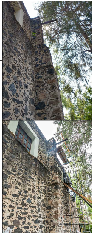
FOTO-01 VISTA DE GRIETA EN CONTRAFUERTE DEL TEMPLO Y DESPLOME.
