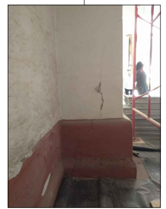
FOTO-02 VISTA DE GRIETA EN PILASTRA QUE PRESENTA PÉRDIDA DE APLANADO EN SU TRAYECTORIA.
