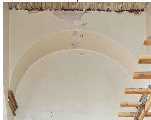
FOTO-01 VISTA DE FISURA, GRIETA, PÉRDIDA DE APLANADO Y APLANADO SUELTO POR FALTA DE COHESIÓN DE LOS MATERIALES EN ARCO FORMERO DE LA NAVE DEL TEMPLO.
