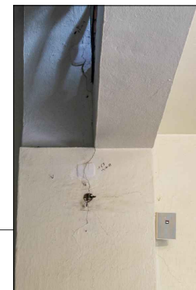
FOTO-05 VISTA DE GRIETA EN PILASTRA Y ARCO FAJÓN.
