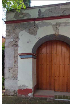
FOTO-01 VISTA DE FACHADA DEL PORTAL DE PEREGRINOS QUE PRESENTA PÉRDIDA DE APLANADO, APLANADO SUELTO POR FALTA DE ADHERENCIA, FISURAS Y GRIETAS.
