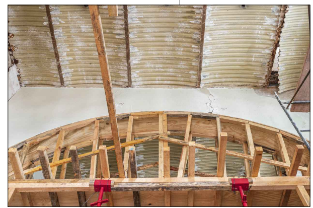
FOTO-04 VISTA DE GRIETAS EN ARCO FAJÓN QUE PRESENTAN APLANADO SUELTO EN SU TRAYECTORIA Y PÉRDIDA DE APLANADO EN SU EXTREMO DERECHO.
