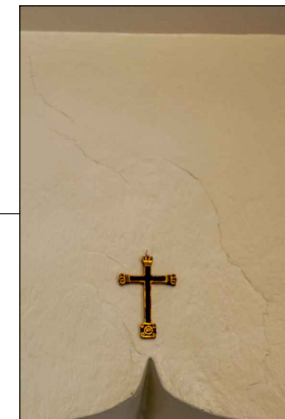
FOTO-06 VISTA DE FISURAS EN EL APLANADO DEL MURO.
