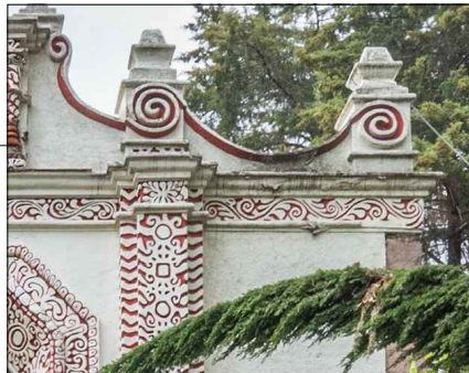
FOTO-04 APLANADO SUELTO POR PÉRDIDA DE COHESIÓN DE MORTERO EN CORNISA Y REMATE DE FACHADA QUE PRESENTA MANCHAS NEGRAS POR ESCURRIMIENTOS.
