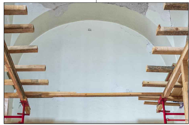
FOTO-04 VISTA DE GRIETAS EN EL MURO.
