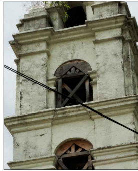
FOTO-02 VISTA DE FISURAS Y GRIETAS EN MUROS DE LA TORRE CAMPANARIO, APLANADO SUELTO POR FALTA DE COHESIÓN DE LOS MATERIALES QUE PRESENTA TAMBIÉN MANCHAS DE HUMEDAD.
