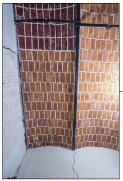
FOTO-01 VISTA DE TRAYECTORIA DE GRIETA POR INTRADÓS DE BÓVEDA CATALANA CONTINUANDO EN MURO.
