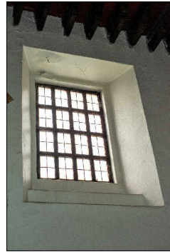
FOTO-01 VISTA DE DERRAME DE VENTANA EN PRESBITERIO QUE PRESENTA GRIETAS.
