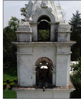
FOTO-05 VISTA DE FISURAS Y GRIETAS EN MUROS DE LA TORRE CAMPANARIO, APLANADO SUELTO POR FALTA DE COHESIÓN DE LOS MATERIALES QUE PRESENTA TAMBIÉN MANCHAS DE HUMEDAD.
