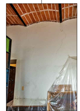
FOTO-02 VISTA DE FISURA EN EL APLANADO Y GRIETA EN MURO DE PORTAL DE PEREGRINOS.
