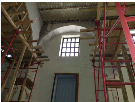
FOTO-06 VISTA DE ARCO FORMERO DE LA NAVE DEL TEMPLO QUE PRESENTA PÉRDIDA DE APLANADO Y APLANADO SUELTO POR FALTA DE COHESIÓN DE LOS MATERIALES.
