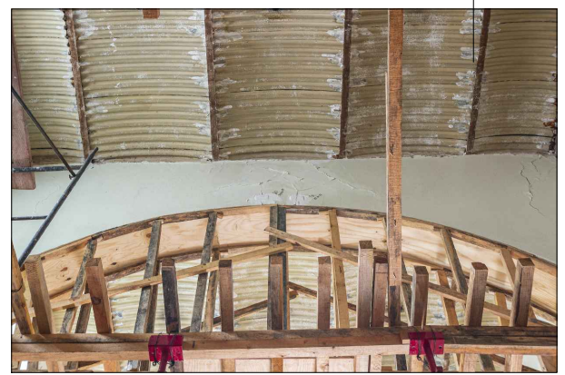
FOTO-03 VISTA DE GRIETAS EN ARCO FAJÓN QUE PRESENTAN APLANADO SUELTO EN SU TRAYECTORIA.
