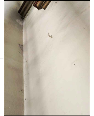
FOTO-05 VISTA DE GRIETA EN LA UNIÓN DE LOS MUROS DE LA NAVE DEL TEMPLO.
