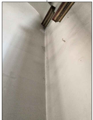
FOTO-04 VISTA DE GRIETA EN UNIÓN DE MURO CON PILASTRA DE ARCO FAJON QUE PRESENTAN APLANADO SUELTO EN SU TRAYECTORIA.
