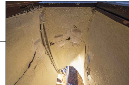
FOTO-02 VISTA DE LECHO BAJO DE CUBIERTA DE ACCESO AL CORO QUE PRESENTA GRIETAS Y RUPTURA DE TESTIGOS DE YESO, LO CUÁL INDICA QUE LA ESTRUCTURA SIGUE TENIENDO AFECTACIÓN POR POSIBLES ASENTAMIENTOS.
