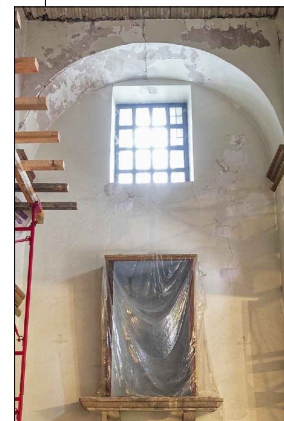
FOTO-04 VISTA DE GRIETAS EN EL MURO.
