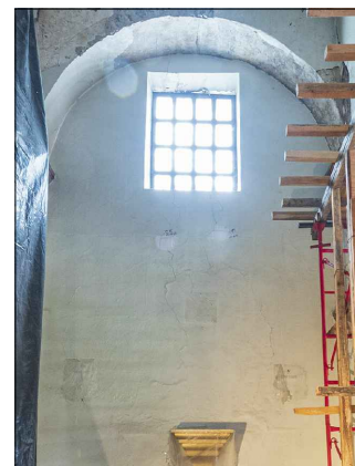
FOTO-02 VISTA DE GRIETAS EN EL MURO.
