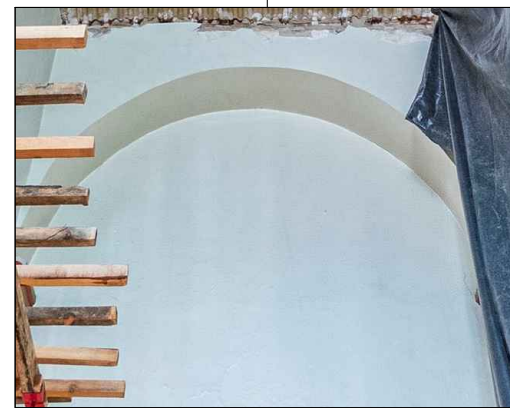
FOTO-03 VISTA DE PÉRDIDA DE APLANADO Y APLANADO SUELTO POR FALTA DE COHESIÓN DE LOS MATERIALES EN EL ARCO FORMERO.
