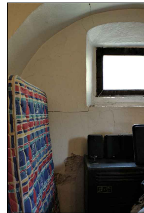
FOTO-07 VISTA DE GRIETAS, FISURAS Y PÉRDIDA DE APLANADO Y MAMPOSTERÍA SUELTA EN EL MURO.
