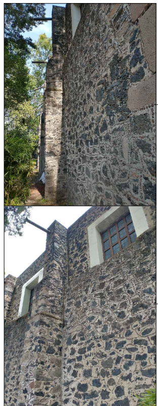
FOTO-02 VISTA DE GRIETA EN CONTRAFUERTE DEL TEMPLO Y DESPLOME.
