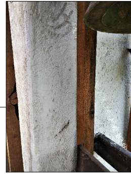
FOTO-04 VISTA DE FISURAS EN PIERNAS DEL PRIMER CUERPO DE LA TORRE CAMPANARIO.
