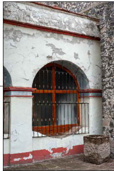
FOTO-03 VISTA DE FACHADA DEL PORTAL DE PEREGRINOS QUE PRESENTA PÉRDIDA DE APLANADO, APLANADO SUELTO POR FALTA DE ADHERENCIA, FISURAS Y GRIETAS.
