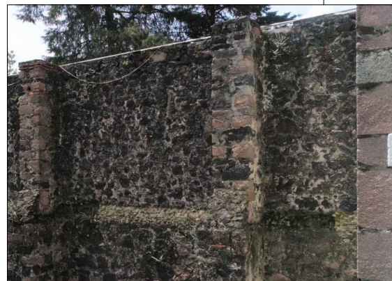
FOTO-02 VISTA DE PÉRDIDA PARCIAL DE MAMPOSTERÍA DE PIEDRA Y MORTERO DE ASIENTO DISGREGADO.
