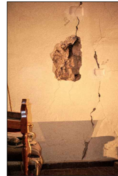
FOTO-06 VISTA DE GRIETA EN EL INTERIOR.
