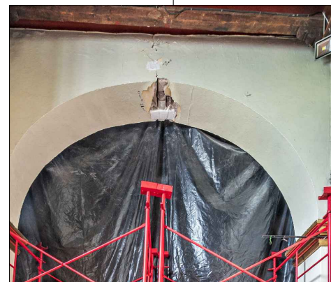
FOTO-02 VISTA DE GRIETA EN ARCO FAJON QUE PRESENTA PÉRDIDA DE APLANADO Y APLANADO SUELTOS POR FALTA DE COHESIÓN DE LOS MATERIALES.
