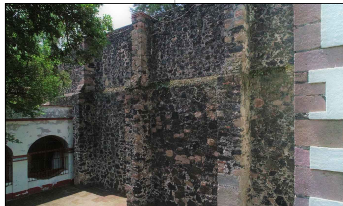
FOTO-01 VISTA DE FLORA Y MICROFLORA NOCIVA EN JUNTAS CON MORTERO DISGREGADO EN FACHADA NORTE.
