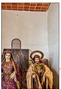
FOTO-04 VISTA DE GRIETA EN JUNTA FRÍA DEL MURO Y FISURA EN EL APLANADO.
