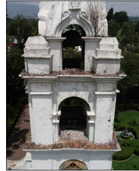
FOTO-11 VISTA DE FISURAS EN EL APLANADO DE LA TORRE CAMPANARIO, APLANADO SUELTO POR FALTA DE COHESIÓN DE LOS MATERIALES QUE PRESENTA TAMBIÉN MANCHAS DE HUMEDAD.
