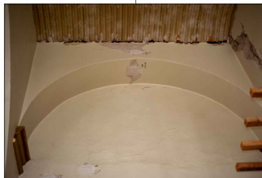
FOTO-04 VISTA DE ARCO FORMERO DE LA NAVE DEL TEMPLO QUE PRESENTA UNA GRIETA AL CENTRO, PÉRDIDA DE APLANADO Y APLANADO SUELTO POR FALTA DE COHESIÓN DE LOS MATERIALES.
