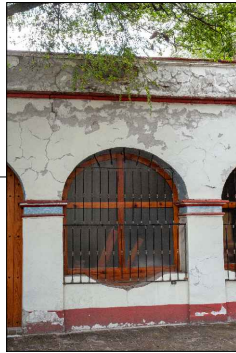
FOTO-02 VISTA DE FACHADA DEL PORTAL DE PEREGRINOS QUE PRESENTA PÉRDIDA DE APLANADO, APLANADO SUELTO POR FALTA DE ADHERENCIA, FISURAS Y GRIETAS.
