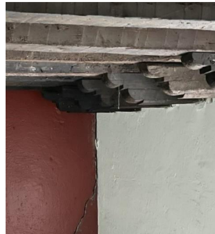
32 Detalle de vigas de madera en el área del presbiterio. Junio 2021. Archivo Sackbé.
