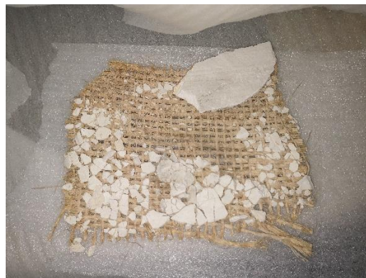
29 Detalle del plafón de yute y yeso. Muestra obtenida de cala realizada en el área de la cubierta del presbiterio. Julio 2021. K.R.V.
