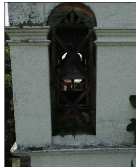
FOTO-09 VISTA DE FISURAS EN MUROS DE LA TORRE CAMPANARIO.
