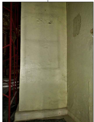
FOTO-07 VISTA DE FISURA EN EL APLANADO EN PILASTRA.
