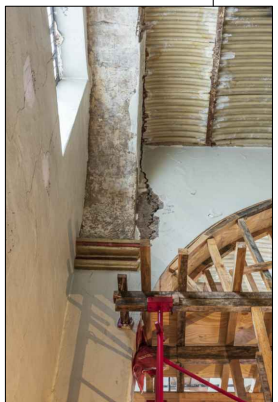
FOTO-01 VISTA DE GRIETA EN ARCO FAJON QUE PRESENTA PÉRDIDA DE APLANADO EN SU TRAYECTORIA.
