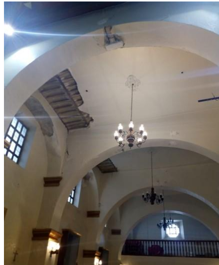
17 Vista del plafón de yute y yeso al interior de la nave del templo parcialmente desprendido. Fotografía obtenida del video "Sesión 3. Situación actual del templo de San Jerónimo Lídice. Acciones para su rehabilitación." Canal de Youtube "Parroquia San Jerónimo Lídice"
