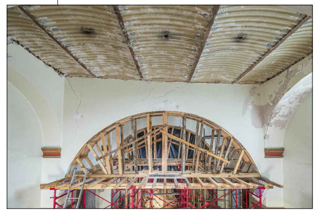
FOTO-01 VISTA DE FISURAS EN EL APLANADO, GRIETAS, PÉRDIDA DE APLANADO Y APLANADO SUELTO POR FALTA DE COHESIÓN DE LOS MATERIALES EN ARCO FAJÓN.
