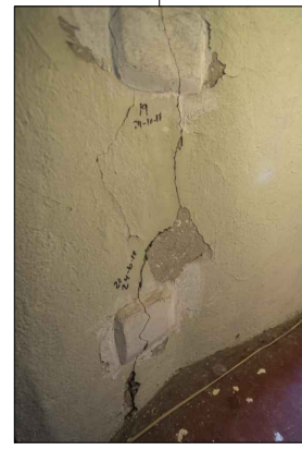
FOTO-01 VISTA DE FISURAS Y GRIETAS EN EL ACCESO AL CORO DESDE LA TORRE CAMPANARIO QUE PRESENTAN PÉRDIDA DE APLANADO Y MAMPOSTERÍA EN EL PASO DE SU TRAYECTORIA.
