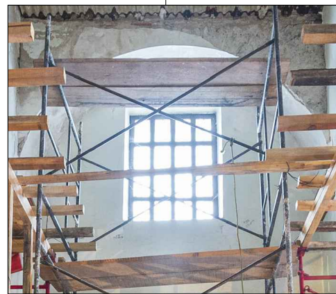
FOTO-02 VISTA DE PÉRDIDA DE APLANADO EN EL ARCO FORMERO.
