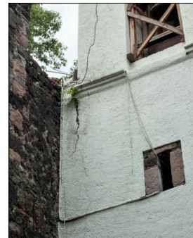
FOTO-12 VISTA DE GRIETA EN MURO DE TORRE CAMPANARIO.
