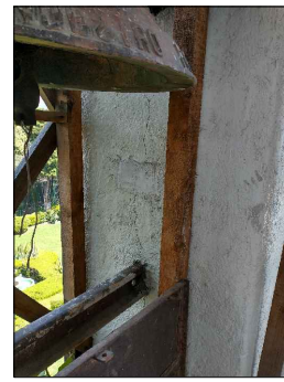
FOTO-05 VISTA DE GRIETAS EN PIERNAS DEL PRIMER CUERPO DE LA TORRE CAMPANARIO.
