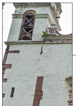
FOTO-02 SEPARACIÓN DE JUNTA FRÍA ENTRE TORRE CAMPANARIO Y MURO DE FACHADA CON PÉRDIDA DE APLANADO.
