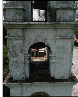
FOTO-08 VISTA DE FISURAS EN EL APLANADO DE LA TORRE CAMPANARIO, APLANADO SUELTO POR FALTA DE COHESIÓN DE LOS MATERIALES QUE PRESENTA TAMBIÉN MANCHAS DE HUMEDAD.
