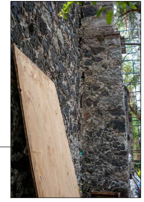
FOTO-01 VISTA DE FRACTURA EN CONTRAFUERTE DEL TEMPLO.
