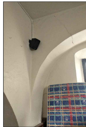
FOTO-08 VISTA DE GRIETAS EN EL MURO.
