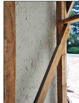
FOTO-08 VISTA DE FISURAS EN PIERNAS DEL PRIMER CUERPO DE LA TORRE CAMPANARIO.
