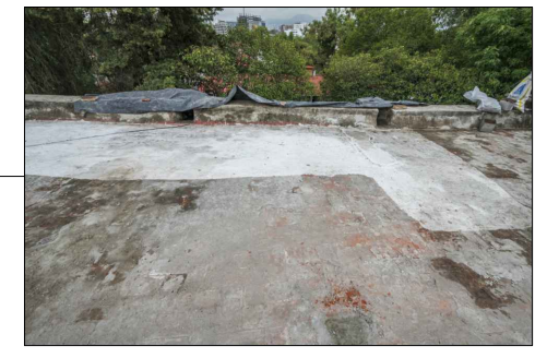
FOTO-02 PÉRDIDA DE COHESIÓN ENTRE CHAFLÁN, MURO Y CUBIERTA GENERANDO FILTRACIONES Y DISGREGACIÓN DE MORTERO.
