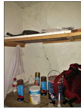
VISTA DE GRIETAS EN MURO DE BODEGA. FOTO-04
