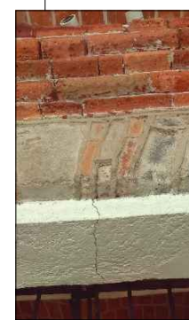
FOTO-03 GRIETA EN DINTEL Y CORNISAMIENTO DE VANO DE ACCESO A PORTAL DE PEREGRINOS.
