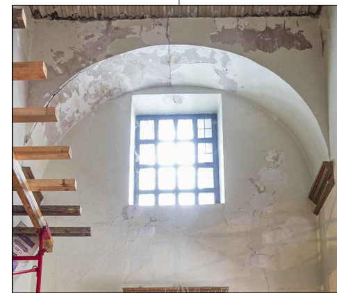
FOTO-03 VISTA DE GRIETA AL CENTRO DEL ARCO FORMERO. PÉRDIDA DE APLANADO Y APLANADO SUELTO POR FALTA DE COHESIÓN DE LOS MATERIALES.
