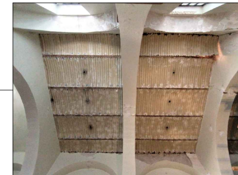
FOTO-02 VISTA DE CUBIERTA DE LÁMINA DE ZINC CON ÁREAS DE CORROSIÓN POR PÉRDIDA DE CAPA PROTECTORA POR EXPOSICIÓN A HUMEDAD DEBIDO A FILTRACIONES EN LA CAPA DE RELLENO.
