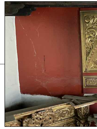
FOTO-06 VISTA DE FISURAS EN EL APLANADO DEL MURO TESTERO.
