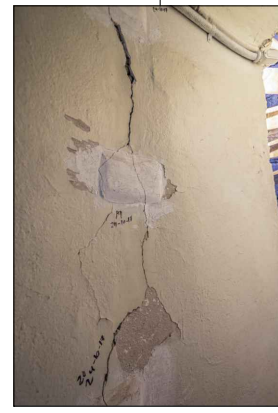
FOTO-02 VISTA DE FISURAS Y GRIETAS EN EL ACCESO AL CORO DESDE LA TORRE CAMPANARIO QUE PRESENTAN PÉRDIDA DE APLANADO Y MAMPOSTERÍA EN EL PASO DE SU TRAYECTORIA.
