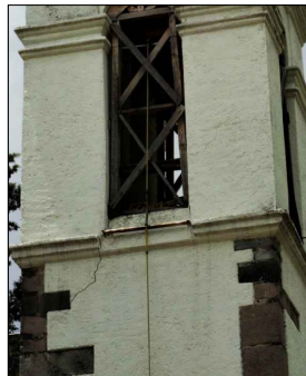
FOTO-03 VISTA DE GRIETA EN MURO DE TORRE CAMPANARIO.
