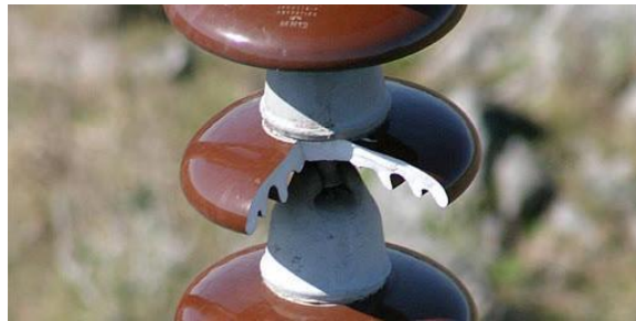
Fig. 30 Aislador de Porcelana fracturado
