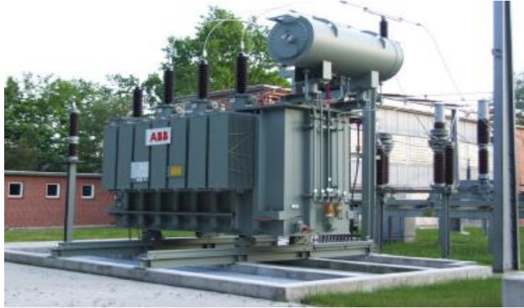
Fig. 10 Transformador de corriente alterna de la compañía ABB
