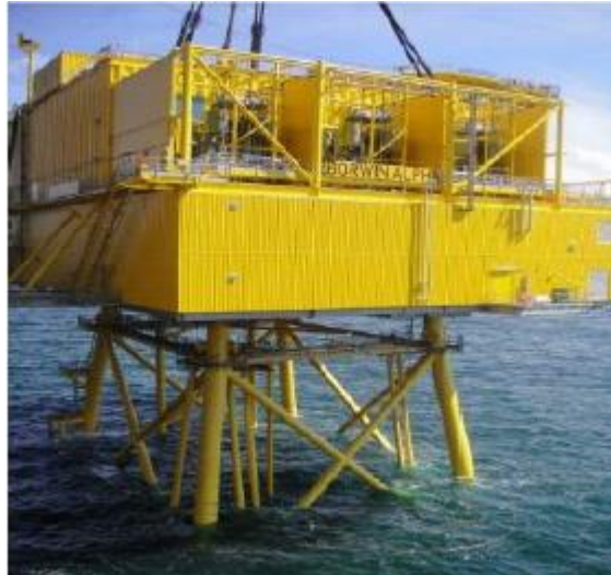
Fig. 93 Plataforma offshore del parque BorWin1
