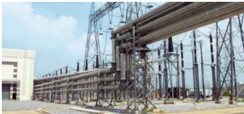
Fig. 56 Instalación GIL sobre el suelo
