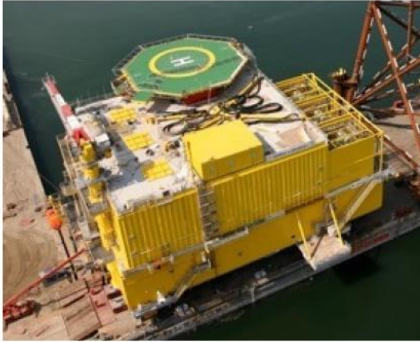
Fig. 64 Estación convertidora HVDC-Light en el Mar del Norte de ABB
