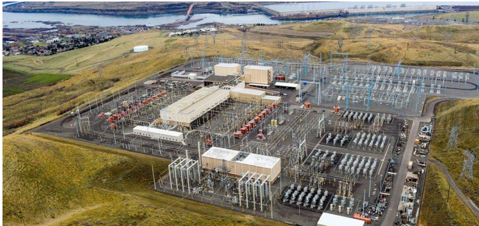
Fig. 105 Estación para líneas de ultra alta tensión en China.
