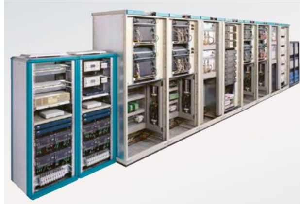
Fig. 40 Los cubículos de control y protección se prueban intensamente en los laboratorios de Siemens antes de enviarlos al sitio, lo que garantiza una puesta en marcha rápida y sin problemas del sistema HVDC.
