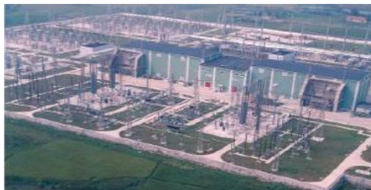
Fig. 98 Estación de conversión de uno de los enlaces HVDC
