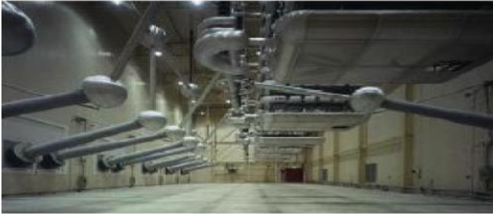
Fig. 99 Interior del edificio de válvulas de una de las estaciones de conversión.
