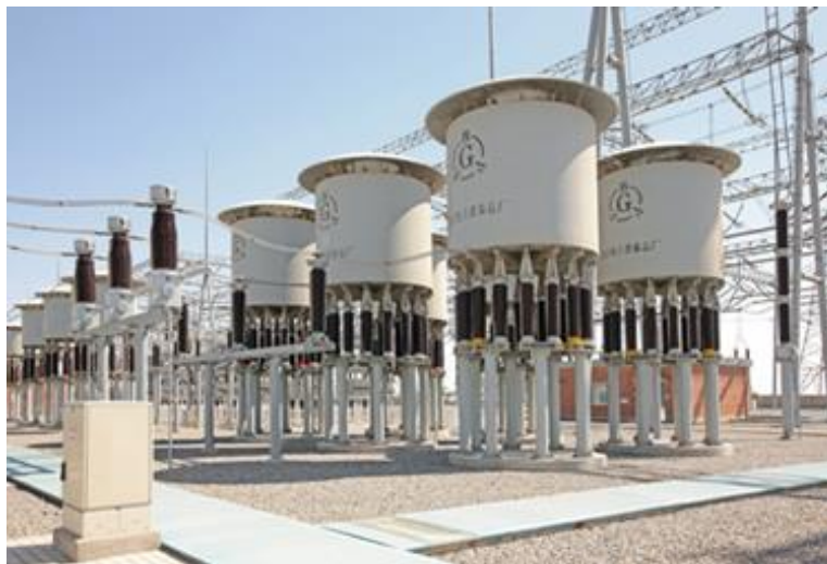
Fig. 25 El reactor de alisado de \pm 800\text{KV} desarrollado independientemente alcanza el nivel avanzado mundial
