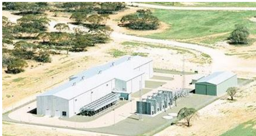
Fig. 102 Estación de conversión en Berry, Australia del Sur.
