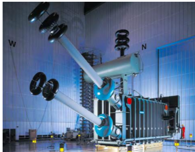
Fig. 8 Transformador convertidor para HVDC, sistema de transmisión bipolar de 500KVDC; 2500 MW: una sola fase: 420 KVAC; 515KVDC; 397 MVA; sistema estrella (lado izquierdo de la figura) y sistema delta (lado derecho de la figura)
