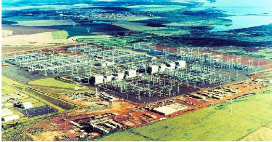
Fig. 96 Estación de conversión de uno de los enlaces HVDC.
