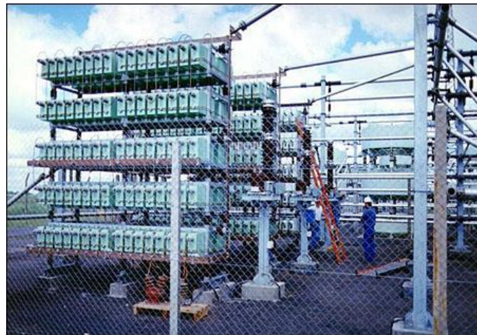
Fig. 26 Banco de capacitores conectados en paralelo.
