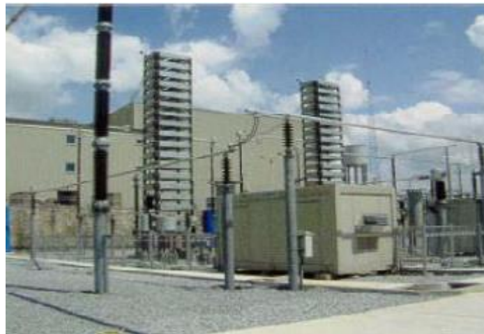
Fig. 6 Filtro de corriente continua en una instalación.
