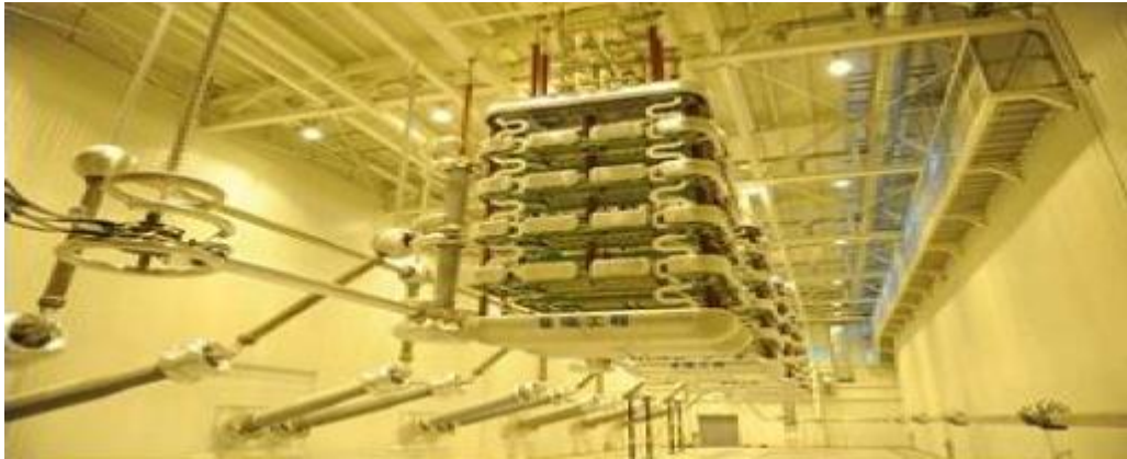
Fig. 101 Sala de válvulas en el enlace Jinping I.
