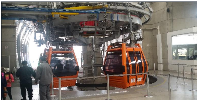
Ilustración 17. Motor de teleférico.
