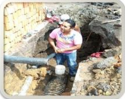
CONEXIÓN DE DESCARGA
