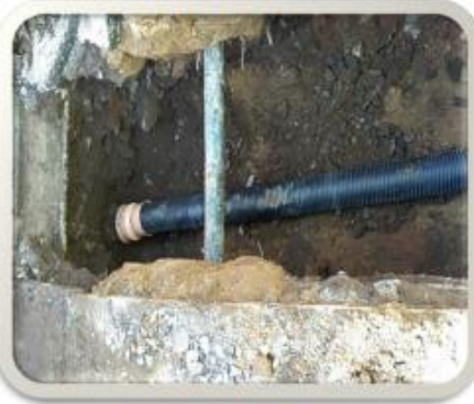
CONEXIÓN DE DESCARGA
