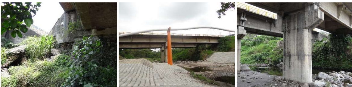
Fig. 15.- Puente Jalapilla Cuerpo A ubicado en el km. 272+800 de la autopista Córdoba – Veracruz, Ver., Méx. Derecha. Vista frontal del alero derecho de estribo 1, en la que se observa en la cimentación de este, socavación local. Central. Protección del fondo y las márgenes del cauce para mitigar la socavación general. Izquierda. La sección transversal del cauce bajo el puente no cuenta con protección alguna para impedir que la socavación progrese. Archivo del autor mayo del 2014.
