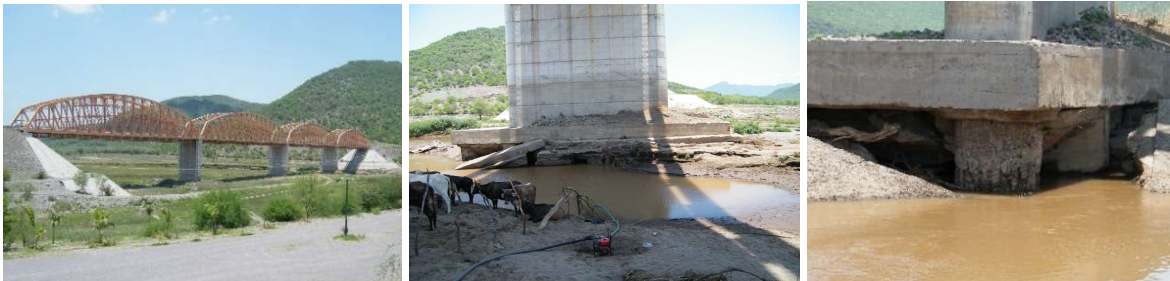
Fig. 8.- Puente Río Márquez ubicado en el km. 171+300 de la autopista Nueva Italia – Lázaro Cárdenas, Mich., Méx. Derecha. Panorámica de la estructura tomada desde el hombro derecho. Central e Izquierda. Acercamiento a la cimentación de la pila 2, la cual se observa expuesta por socavación local. Archivo del autor junio del 2009.
