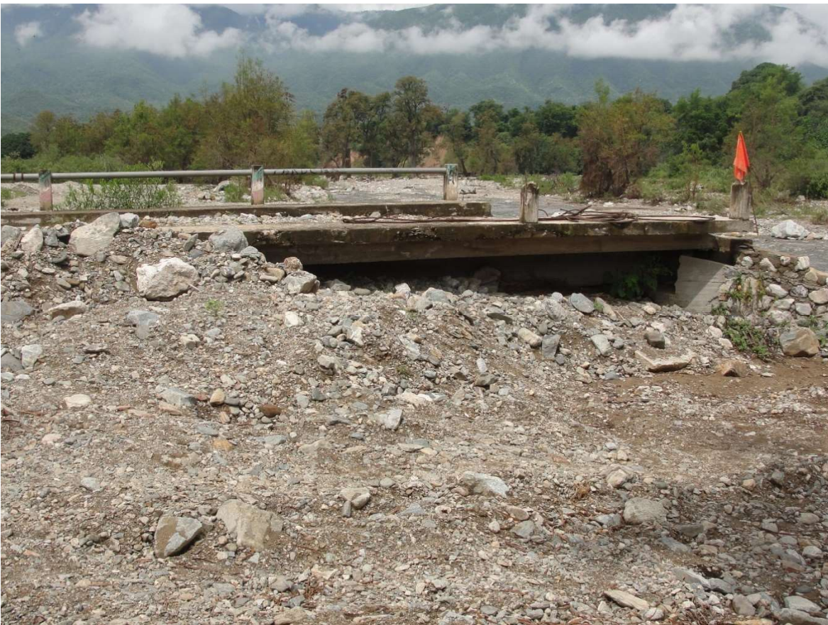
El tránsito de una avenida atípica sobre el río Chiquito, Oax. México provocó el colapso del terraplén de salida y azolvamiento del puente. Archivo del autor diciembre del 2012.
