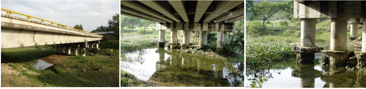
Fig. 10.- Puente Arroyo Talaxco ubicado en el km. 192+212 de la autopista Gutiérrez Zamora – Tihuatlán, Ver., Méx. Derecha. Panorámica de la estructura tomada desde el hombro derecho. Central. Aspecto del Caballete 2. Izquierda. Acercamiento a la cimentación del caballete 2 para resaltar la socavación total del cauce. Se notan las columnas desfasadas. Archivo del autor junio del 2009.
