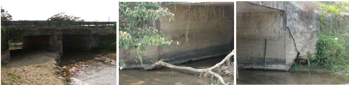
Fig. 14.- Antiguo Puente El Polulu ubicado en el km. 11+170 de la autopista Las Choapas – Raudales – Ocozacoautla, Ver., Méx. Derecha. Panorámica de la estructura tomada desde el hombro derecho. Central. Desplome de la pila 2 como consecuencia de la socavación total del tramo 1-2. Izquierda. Socavación total del tramo 1-2 que ha provocado el asentamiento del estribo 1 y la fractura de su alero izquierdo. Archivo del autor mayo del 2012.
