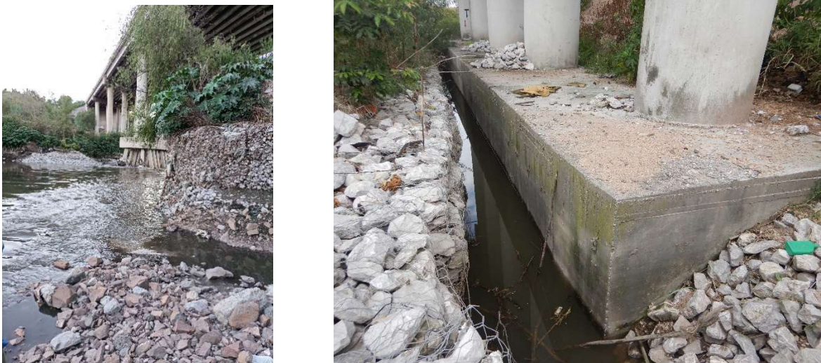
Fig. 7. - Izquierda. Fotografía tomada el 16 de junio de 2021, en la que se distingue la fuerte socavación general del cauce que abarca desde el caballete 3 hasta el 6. Incluso se nota el lavado de material en derredor de la protección de enrocamiento del caballete 4 que se observa al frente de la imagen. Derecha. Acercamiento a la cimentación protegida con gaviones del caballete 3, para resaltar el lavado del material en derredor de ella. Esta situación se observó similar en las fechas del 16 de junio y 08 de agosto de 2021. Fotografías archivo del autor.
