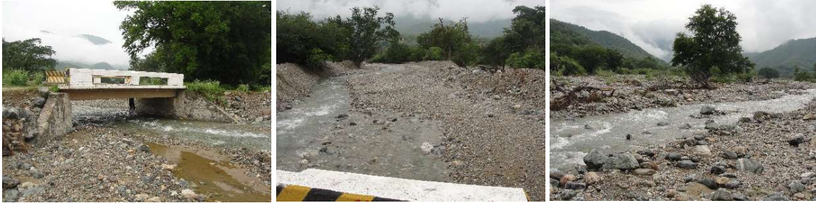
Fig. 19.- Puente sobre el Río Limón ubicado en la Sierra de Oax., Méx. que comunica el poblado de la Unión y San Juan Bautista Atlatlahuca. Derecha. Panorámica derecha de la estructura tomada desde aguas arriba del cauce. Su longitud es insuficiente y el galibo vertical escaso. Su emplazamiento provoca una contracción importante, de alta capacidad que incluye cuerpos flotantes y competencia de gran diámetro. Central. Vista tomada desde el hombro derecho de la estructura y hacia aguas arriba del cauce. Se aprecia un lecho muy ancho, la corriente divagante y trenzada. Izquierda. Otra vista del cauce en un tramo del río y hacia aguas arriba que permite justificar el empleo de obras hidráulicas adicionales que permitan encauzar y dirigir la corriente para cerrar brazos y concentrar el flujo y así generar una morfología estable. Archivo del autor enero del 2013.
