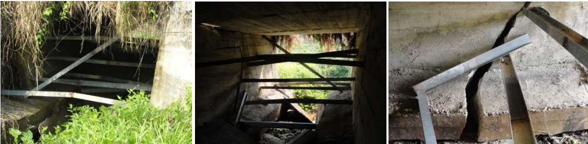
Fig. 20.- Puente Sin Nombre ubicado en el km. 7+519 de la autopista Las Choapas – Raudales – Ocozacoautla, Ver., Méx. Las fotografías derecha, central e izquierda muestran distintos ángulos del colapso de la estructura por socavación. Nótese la superestructura flexionada, los estribos y su cimentación desplomados hacia el interior, la losa de fondo destruida y el apuntalamiento para contener los muros de la subestructura, flexionado y fallado. Archivo del autor junio del 2009.
