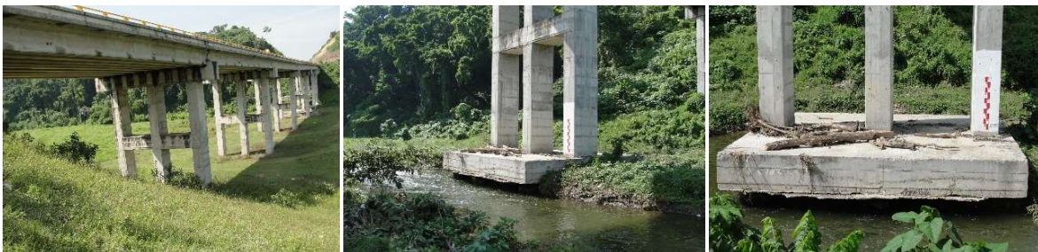
Fig. 9.- Puente Arroyo Puerco ubicado en el km. 190+935 de la autopista Gutiérrez Zamora – Tihuatlán, Ver., Méx. Derecha. Panorámica de la estructura tomada desde el hombro derecho. Central e Izquierda. Acercamiento a la cimentación del caballete 7 para observarla expuesta por socavación local. Archivo del autor junio del 2009.
