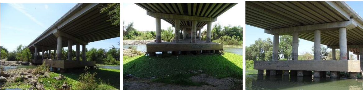
Fig. 21.- Puente Río Presidio ubicado en el km. 242+880 de la autopista Libramiento Mazatlán, Sin., Méx. Derecha. Panorámica de la estructura tomada por el hombro izquierdo, se distingue la socavación general del cauce bajo los caballetes 13 al 15. Central. Acercamiento al caballete 13 para resaltar la magnitud de la socavación. Izquierda. Vista lateral izquierda del caballete 14 en la que se nota su cimentación descubierta como consecuencia de la deformación vertical del lecho. Archivo del autor junio del 2021.
