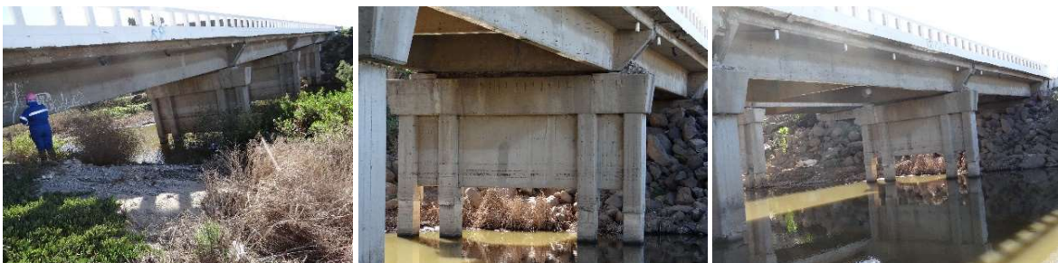
Fig. 12.- Puente El Descanso Cuerpo B ubicado en el km. 56+175 de la autopista Tijuana – Ensenada, Baja California, Méx. Derecha. Panorámica de la estructura tomada desde el hombro derecho. Central. Aspecto de la socavación activa y total del cauce. Izquierda. Se distingue la socavación total en los apoyos de ambos cuerpos del puente. Archivo del autor noviembre del 2015.
