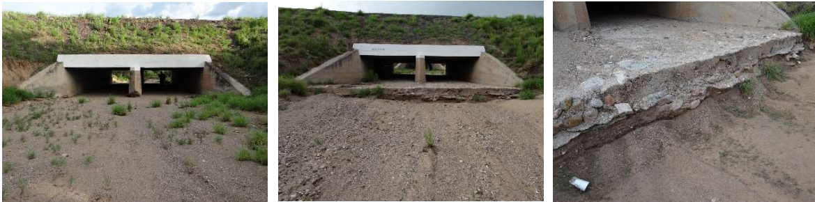
Fig. 13.- Puente Sin Nombre ubicado en el km. 194+500 del Libramiento de Magdalena de Kino, Son., Méx. Derecha. Panorámica de la estructura tomada desde el hombro derecho. Central. Aspecto de la losa de fondo por el hombro izquierdo de la estructura. Izquierda. Socavación general bajo la losa de fondo. Archivo del autor julio del 2015.
