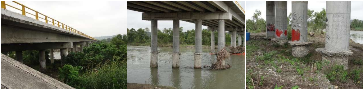
Fig. 11.- Puente Cazonces III ubicado en el km. 206+750 de la autopista Gutiérrez Zamora – Tihuatlán, Ver., Méx. Derecha. Panorámica de la estructura tomada desde el hombro derecho. Central. Aspecto de la socavación activa y general del cauce. A partir del caballete 3 se distingue ausencia de material sedimentario que sostenga el equilibrio dinámico en el cauce, por lo que la magnitud de la socavación es alta. Izquierda. Acercamiento a la cimentación de uno de los caballetes para hacer notar la deformación del fondo del cauce. Archivo del autor junio del 2009.
