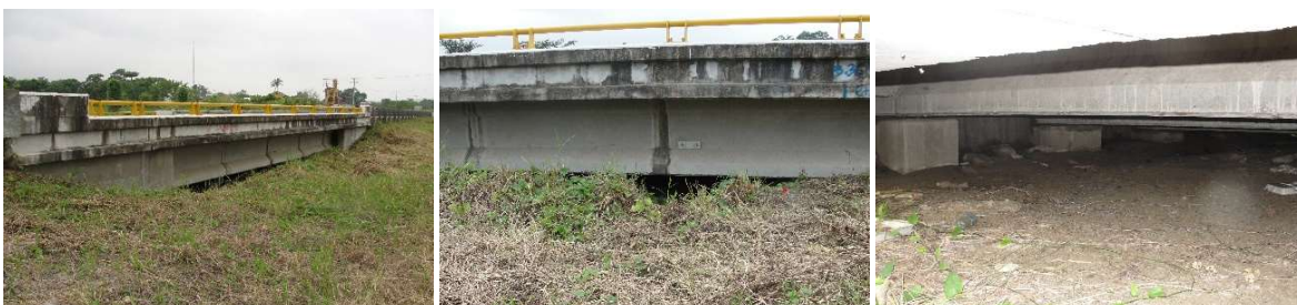
Fig. 17.- Puente Ducto PEMEX ubicado en el km. 205+676 de la autopista Gutiérrez Zamora – Tihuatlán, Ver., Méx. Derecha. Panorámica de la estructura tomada por el hombro izquierdo. Central. Acercamiento al centro de la estructura para destacar que se encuentra casi por completo azolvada. Izquierda. Vista interior de la estructura tomada desde el hombro derecho, en la que se nota el escaso galibo vertical como consecuencia de la agradación del lecho. Archivo del autor junio del 2009.
