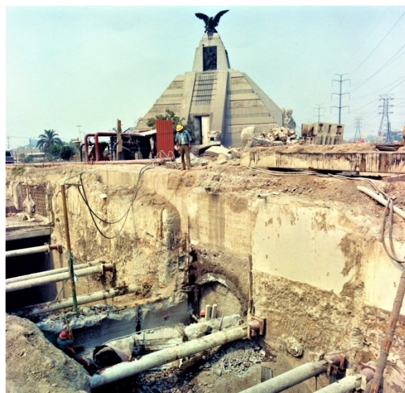
Ilustración 72. Construcción Línea 3 del metro frente al monumento a la Raza. Fuente: FICA, 1977.
