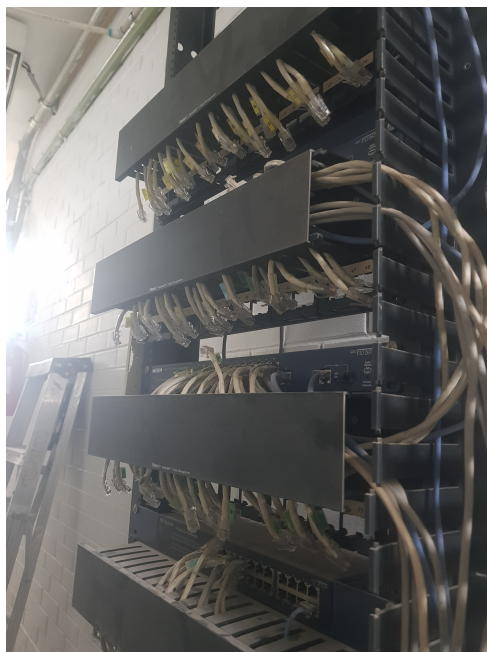
Figura 2.2: Rack con equipo de red
