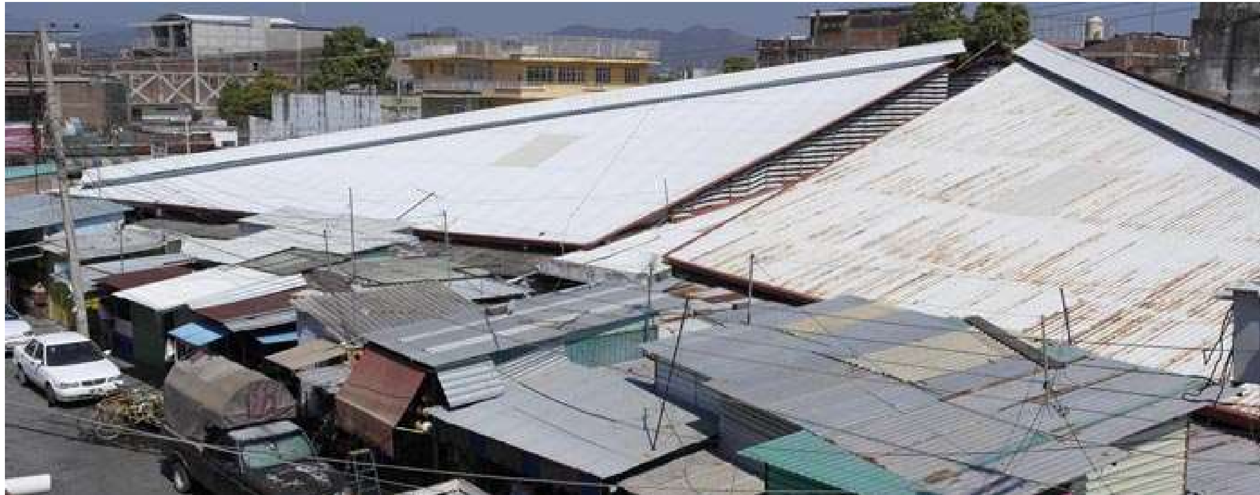
Fotografía 8: Último registro fotográfico del conjunto; se aprecia el deterioro de la cubierta y la invasión de puestos ambulantes en las calles circundantes y la plaza de acceso. Fuente: Archivo del periódico "El Universal"
