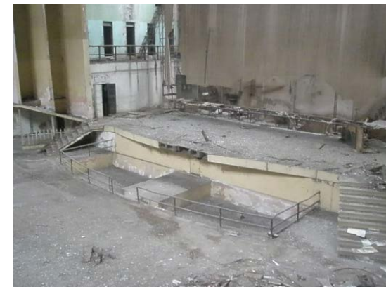
D-02 EL ESCENARIO DE MADERA PRESENTA DETERIORO POR HUMEDAD Y FLORA NOCIVA
