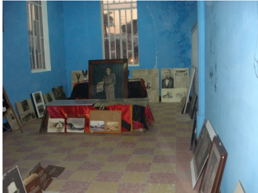
D-17 PRESENCIA DE HUMEDAD EN LA MAYOR PARTE DE LOS PARAMENTOS INTERNOS DEL SALON AZUL.
