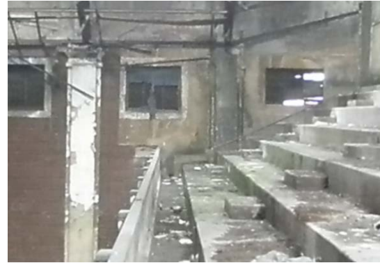
D-18 PRESENCIA DE MANCHAS Y EXCESO DE EXCREMENTO DE PALOMA EN LA GADERIA DEL ANFITEATRO.
