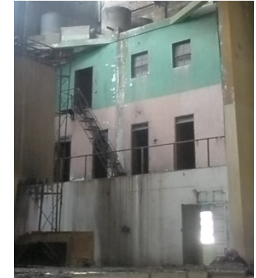
D-20 PRESENCIA DE MANCHAS Y EXCESO DE EXCREMENTO DE PALOMA EN LASCUBIERTAS DE LOS CAMERINOS.
