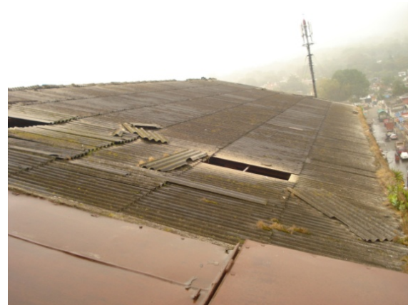
D-25 PERDIDA DE UNA PARTE DE SUS CUBIERTA POR DEGRADACION PROPIA DEL MATERIAL, Y PRESENCIA DE FLORA Y MICRO FLORA POR ACUMULACION DE TIERRA EN SUS CANALONES.
