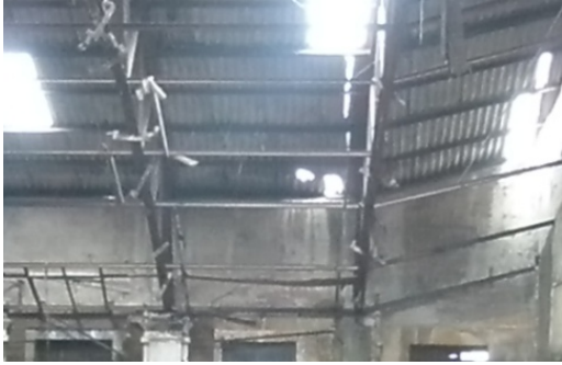
D-28 PERDIDA DE PLAFONES DE MANTA DE CIELO POR PRESENCIA DEL PASO DE LLUVIA AL INTERIOR POR LA PERDIDA DE CUBIERTA.
