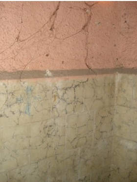
D-16 PIEZAS SUELTAS Y DESCONCHADAS ASI COMO CON RUPTURA.
