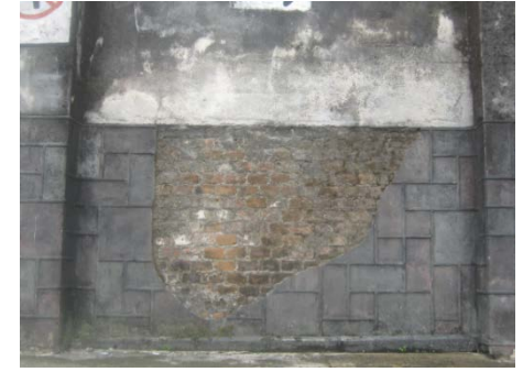
D-07 PERDIDAS PARCIALES DE ACABADOS A NIVEL DEL RODAPIEDE EN LOS PARAMENTOS EXTERIORES
