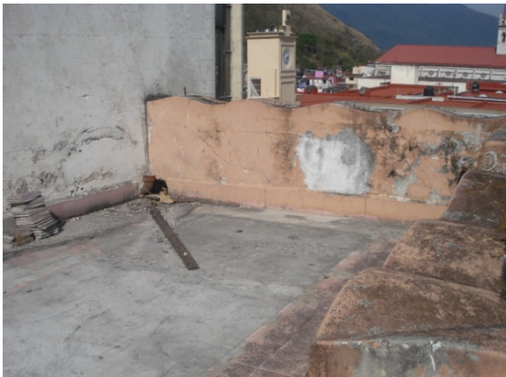
D-26 PERDIDA DE ACABADOS POR LA PRESENCIA DE HUMEDAD EN LOS PARAMENTOS DEL PRETEL UBICADO SOBRE EL SALON AZUL, ASI COMO PRESENCIA DE MICROFLORA.
