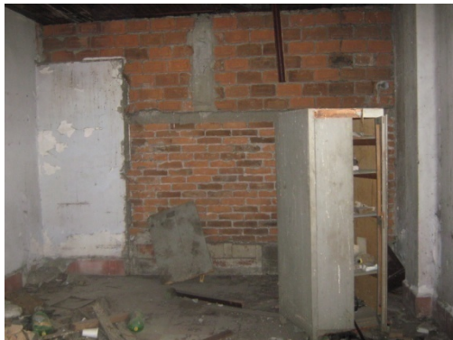
D-21 VANOS CEGADOS CON TABIQUE ROJO RECOCIDO Y REFORZADOS CON ARMADOS DE CONCRETO.
