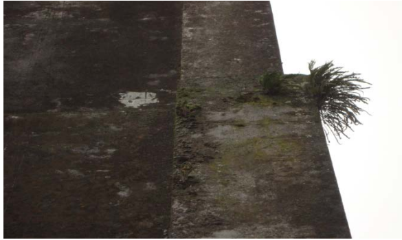
D-11 LA PRESENCIA DE FLORA NOCIVA ASI COMO EFLORESCENCIAS EN SUS ELEMNETOS ESTRUCTURALES, PRINCIPALMENTE EN SUS COLUMNAS.
