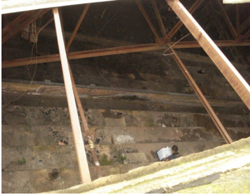
D-27 PRESENCIA DE HERRUMBRE EN LA ARMADURA PORTANTE DE SU CUBIERTA.
