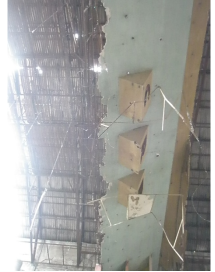
D-29 PERDIDA DEL FALDON DE PANEL DE YESO POR EL PASO DE AGUA DE LLUVIA AL INTERIOR DERIVADO DE LA PERDIDA DE SU CUBIERTA.
