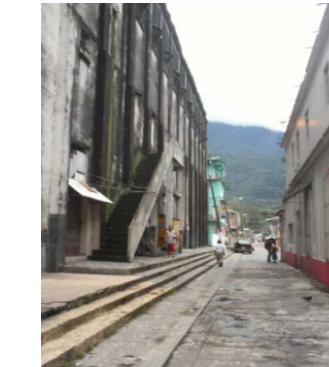
D-09 PRESENTA SALINIDAD Y EFLORESCENCIAS EN SUS PARAMENTOS EXTERIORES POR ESCURRIMIENTO DE AGUA PLUVIAL.
