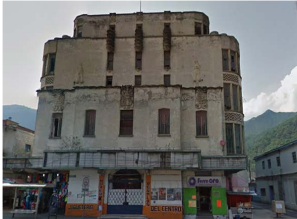
D-10 SU FACHADA PRESENTA PERDIDA DE ACABAOD ASI COMO PRESENCIA DE FLORA PARASITA Y AGREGADOS DISCORDANTES .
