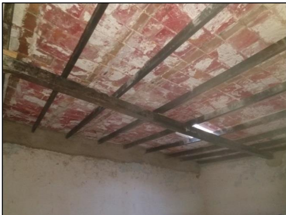
Imagen 5.5. Sustitución de materiales constructivos debido a los costes de mantenimiento
