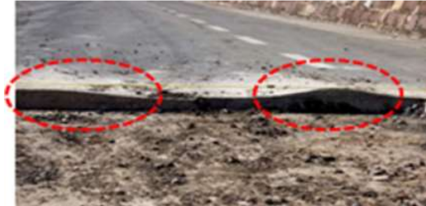
Figura 2.13. Deformación dilatada en pavimentos asfálticos (J. Zhang y J. Yang, 2016)
