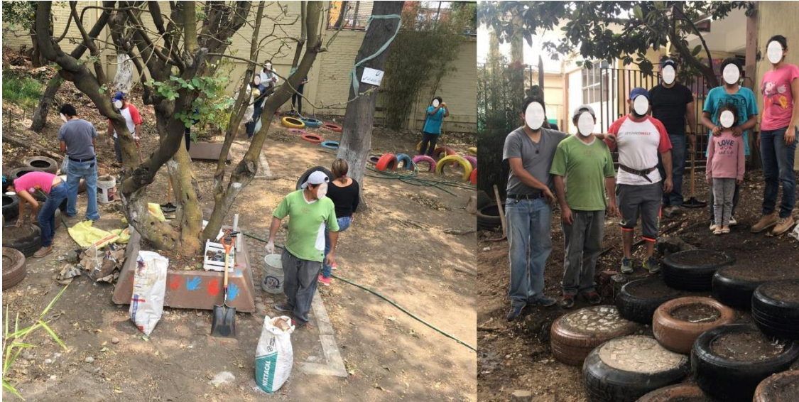
Anexo 12. Padres de familia y comunidad escolar trabajando en conjunto con la comunidad universitaria, en la rehabilitación de diferentes áreas de la escuela.
