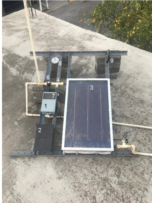
Figura 5.1: Instalación del colector solar y equipo de monitoreo. 1 Gabinete del circuito, 2 Paneles solares para alimentación, 3 Colector solar plano de baja temperatura, 4 Sensor de temperatura de agua a la salida del colector, 5 Sensor de temperatura de agua a la entrada del colector, 6 Caudalímetro, 7 Sensor de irradiancia, 8 Gnomon, 9 Inclímetro.
