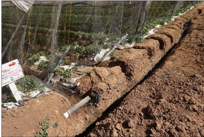
Figura IV-22. Fotografía de los drenes en la zona de Tiripetio.
