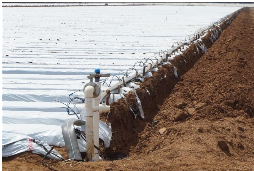
Figura IV-21. Fotografía de las tuberías de distribución de agua de riego.
