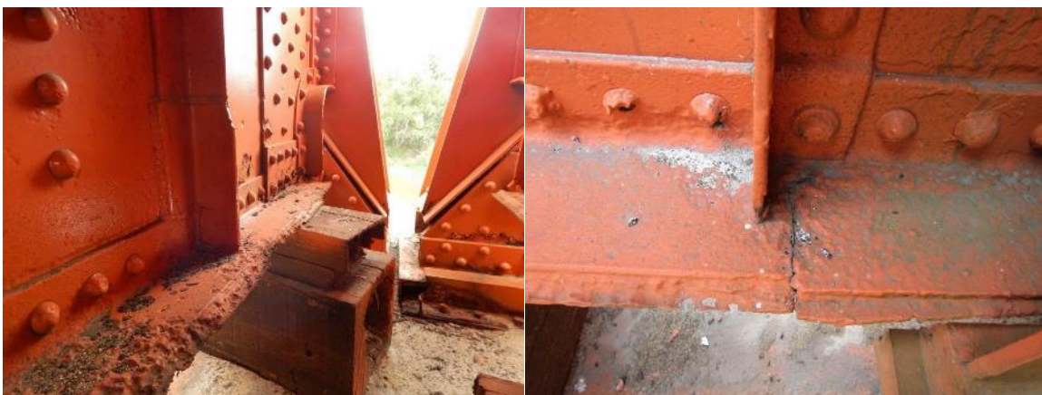
Figura 21. (a) pérdida de sección en patín inferior de piezas puente extremas y (b) fractura en pieza puente sobre la pila No. 4
