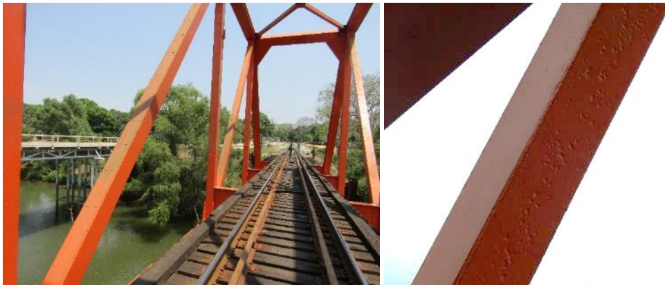
Figura 16. (a) Diagonal vista general y (b) ligera corrosión en placas de refuerzo en diagonales
