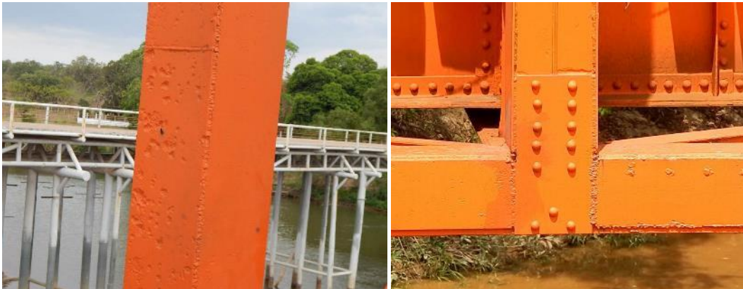
Figura 15. (a) Ligera corrosión en montenes y (b) conexión de montenes con cuerda inferior.
