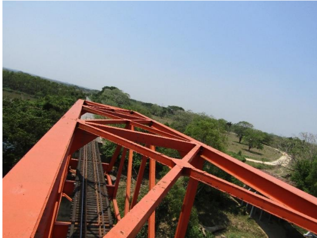
Figura 50. Contraventeos superiores sustituidos.
