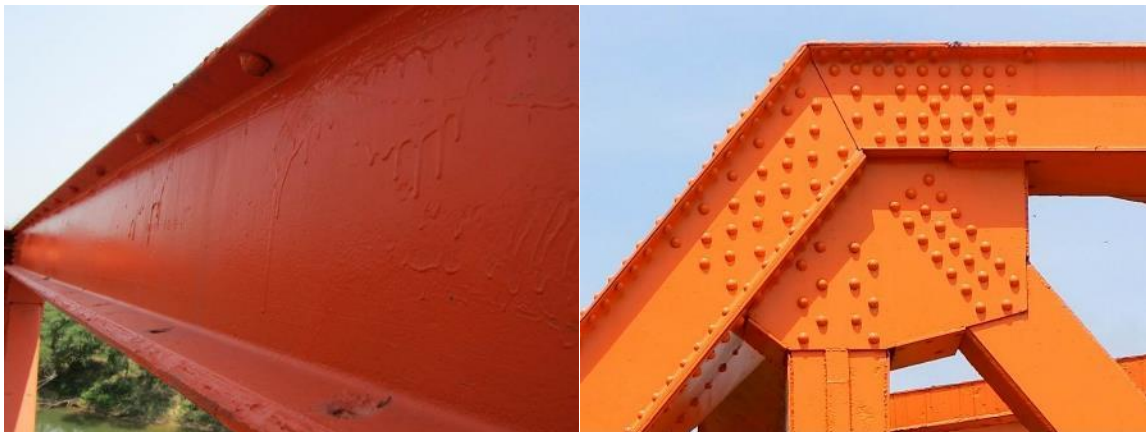
Figura 12. (a) Cuerda superior y (b) conexión cuerda superior y portal de salida
