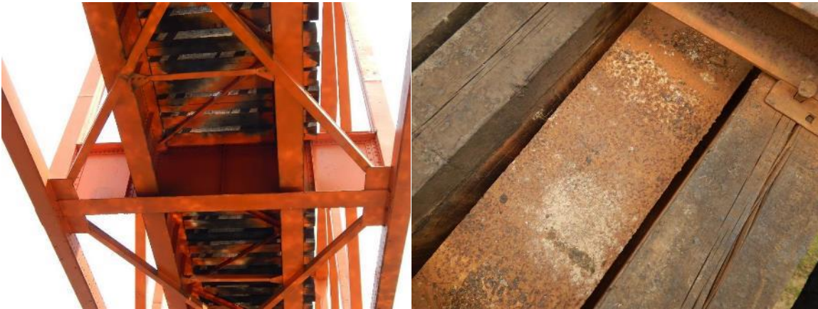
Figura 20. (a) Vista general de las piezas puente y (b) patín superior de piezas puente
