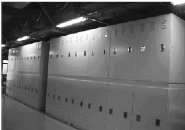
Figura 27: Sistema de 500 kW para la nivelación de cargas (cubículos de baterías) [8].
