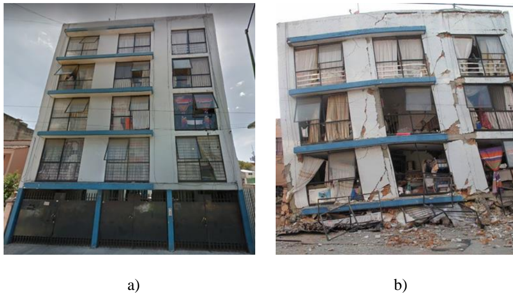
Figura 2.12 Edificio con planta baja débil en Saratoga 714, Portales Sur, Benito Juárez: a) antes (Google Street View) y b) después (Gómez, 2017) del sismo del 19S 2017.
