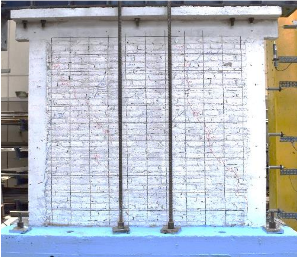
Figura 4.30. Daños en el muro 4 a una distorsión de 0.0015.
