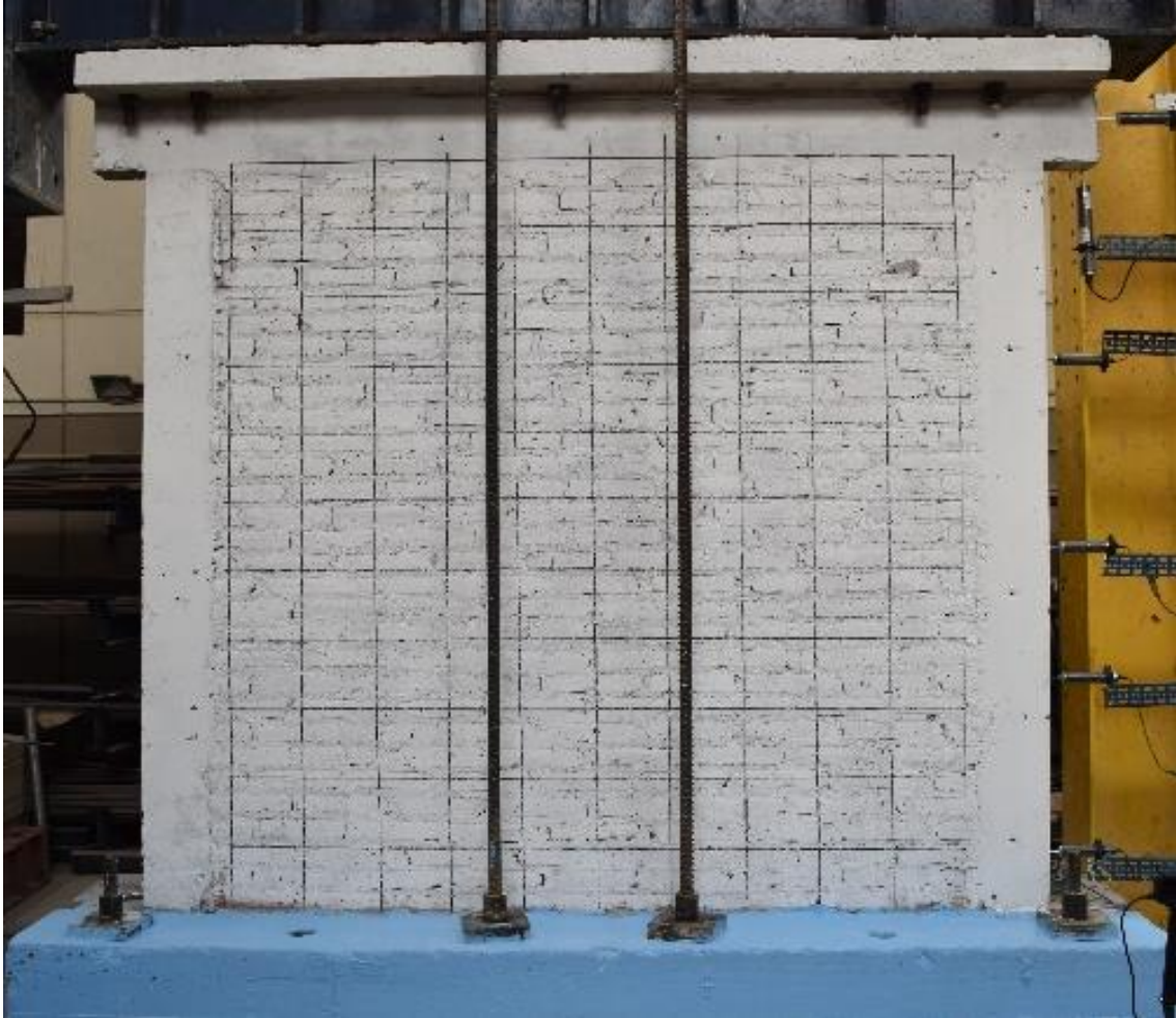
Figura 4.29. Muro 4 al final de la etapa controlada por carga.
