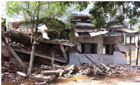
c. Acercamiento a la estructura colapsada.
