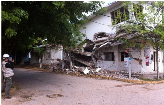
a. Vivienda colapsada tras sismo de septiembre 2017
