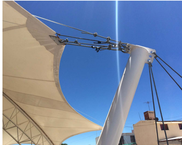
Cables de relinga. Cubierta para cancha deportiva en Durango, México. https://www.lymarquitecturatextil.com
