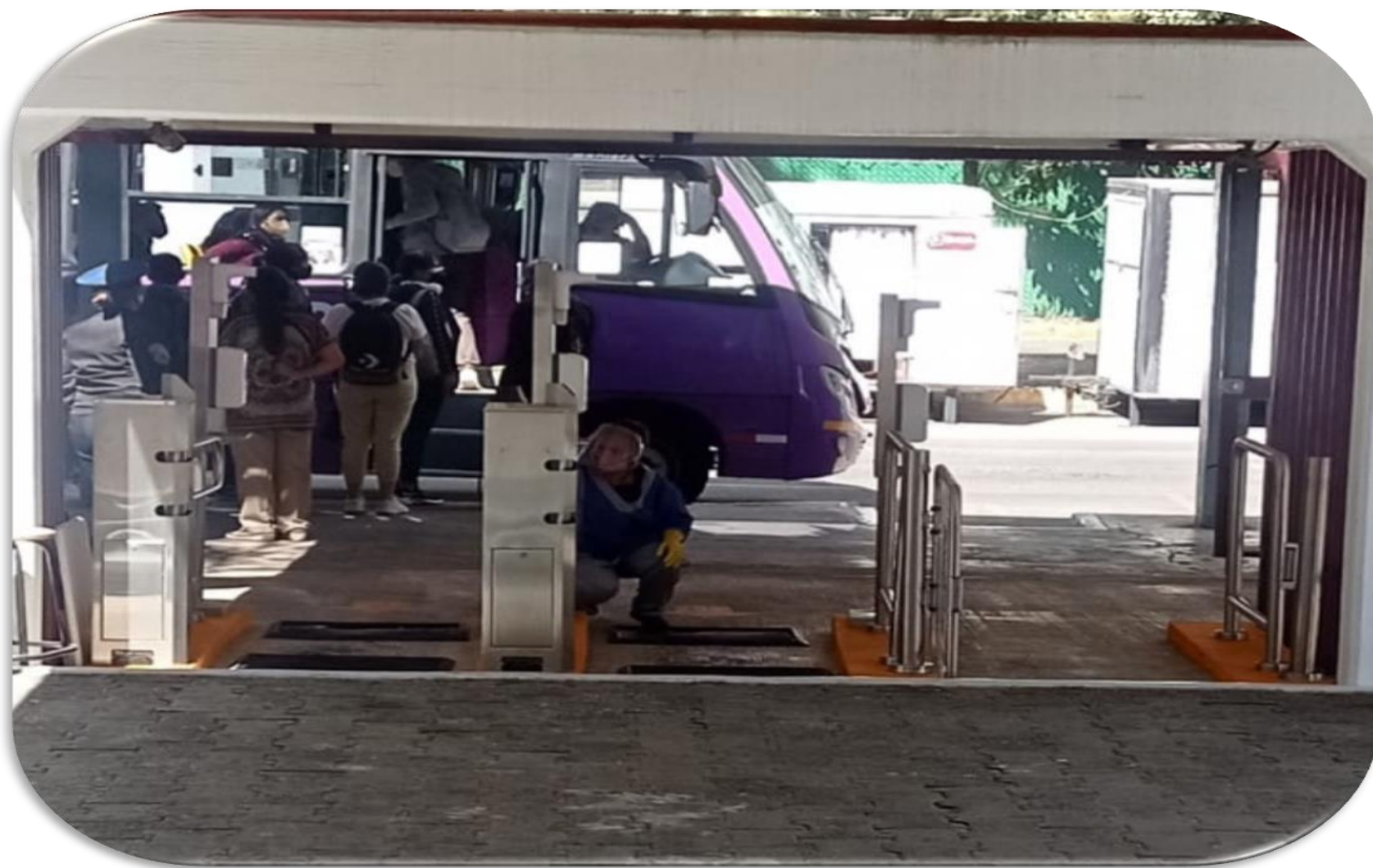
Figura. 8.- Sustitución de torniquetes manuales por torniquetes automáticos en la entrada peatonal principal.
