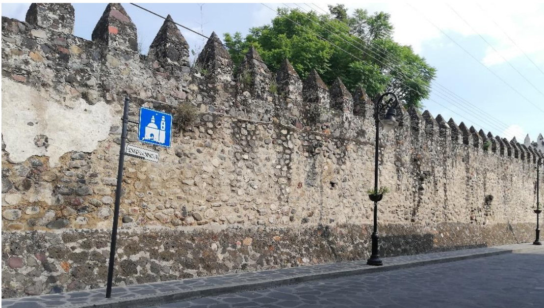
Imagen 40. Cimientos en escarpe que sostienen la barda atrial oeste. Fotografía: Leticia Domínguez Hernández, 2019.
