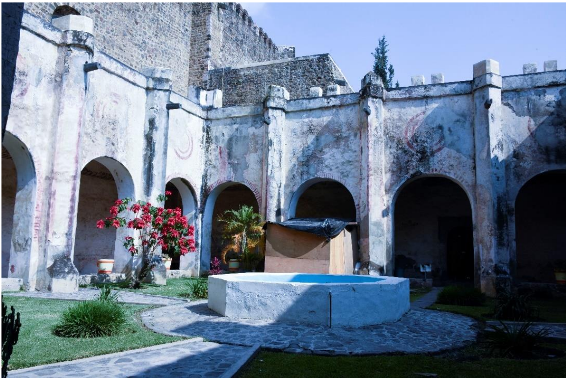
Imagen 95. Claustro del convento. Fotografía: Eumelia Hernández, Laboratorio de Diagnóstico de Obras de Arte, Instituto de Investigaciones Estéticas, UNAM, 2019.
