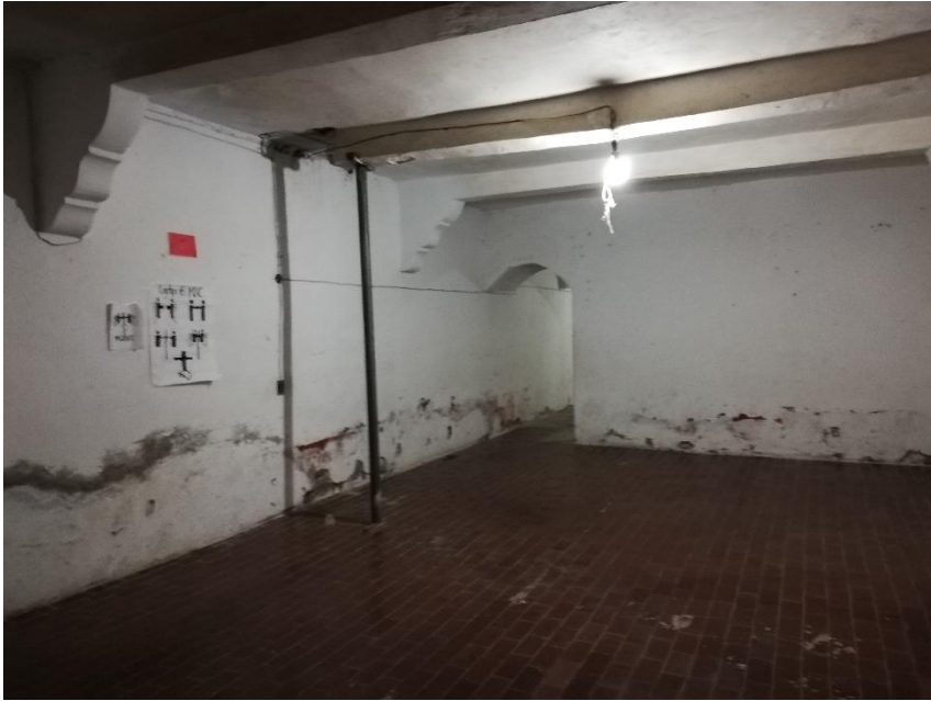
Imagen 121. Trabes de concreto y barra de metal que sostienen al edificio del lado oeste para evitar su hundimiento. Fotografía: Leticia Domínguez, 2019.
