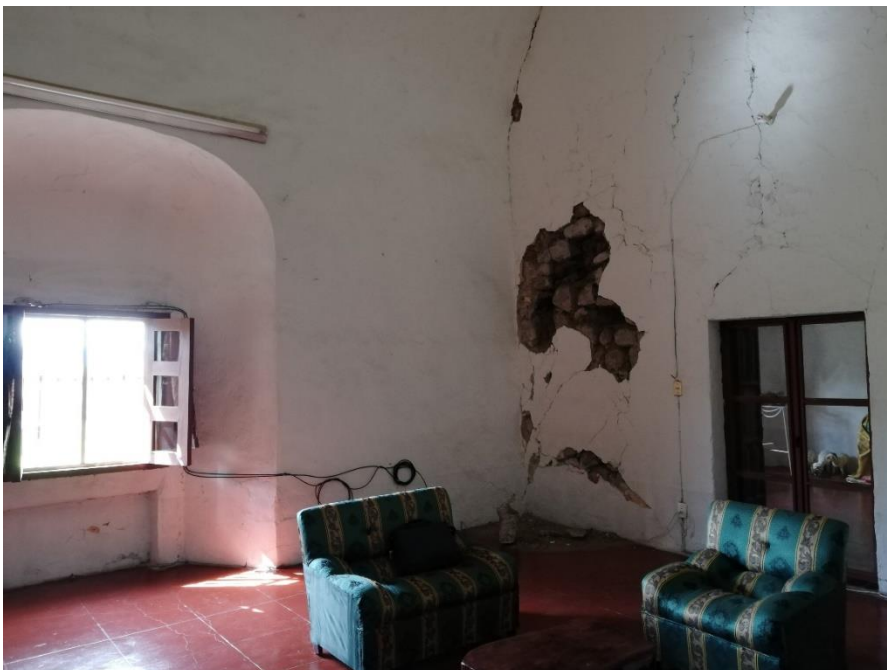
Imagen 129. Habitación que actualmente se utiliza como sala por parte de los párrocos. Debido al sismo del 2017 se cayeron parte de los enlucidos que cubrían los muros, lo que dejó ve parte de su material constructivo. Fotografía: Eumelia Hernández, Laboratorio de Diagnóstico de Obras de Arte, Instituto de Investigaciones Estéticas, UNAM, 2019.
