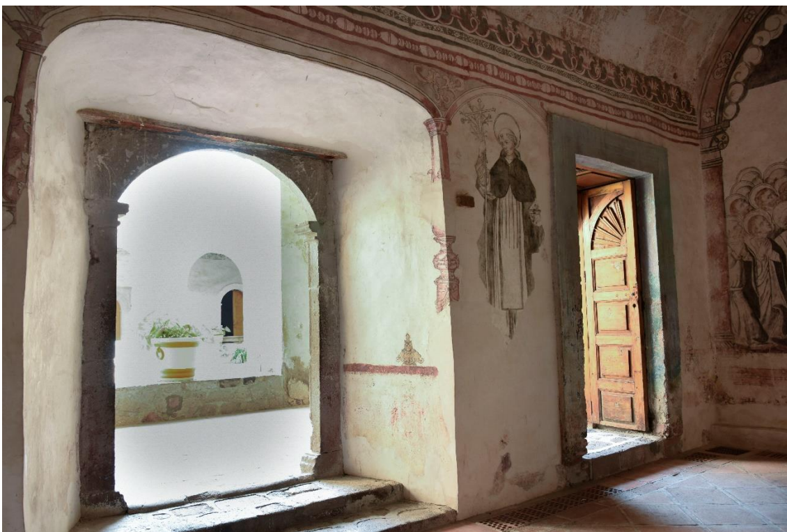
Imagen 139. Vanos de acceso al claustro. Del lado izquierdo se observa que el arco en esviaje fue el primero en realizarse y después se abrió el del lado derecho. Fotografía: Leticia Domínguez, 2019.
