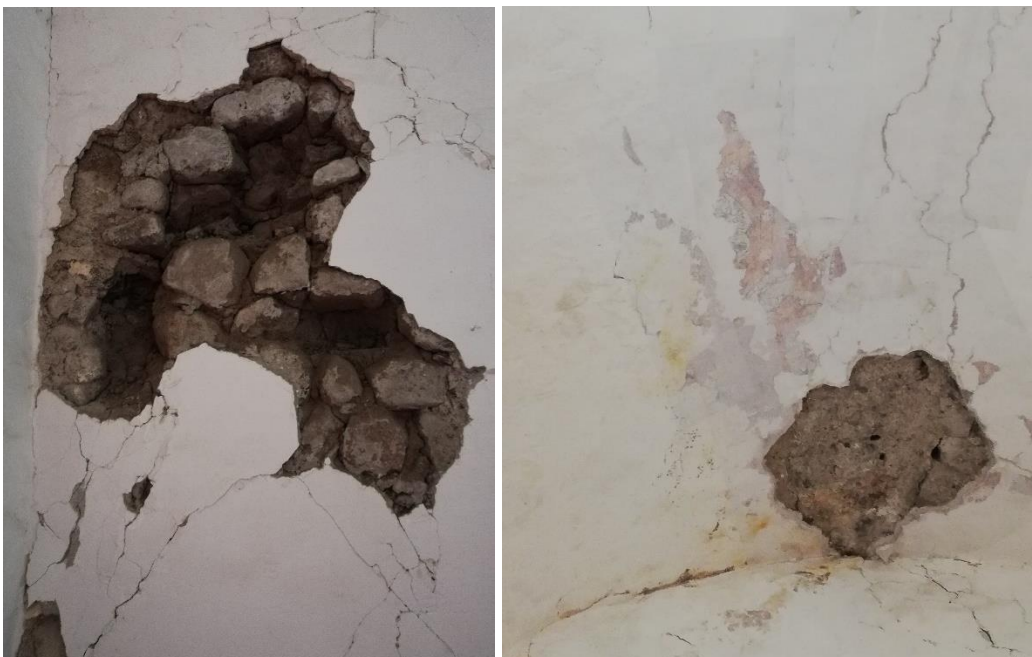
Imágenes 123-124. Material de relleno con el cual fueron construidos los muros del ala oeste del convento. En una de las habitaciones se logra observar parte del terrado de las bóvedas y una pequeña muestra de la decoración mural que hubo. Fotografías: Leticia Domínguez, 2019.
