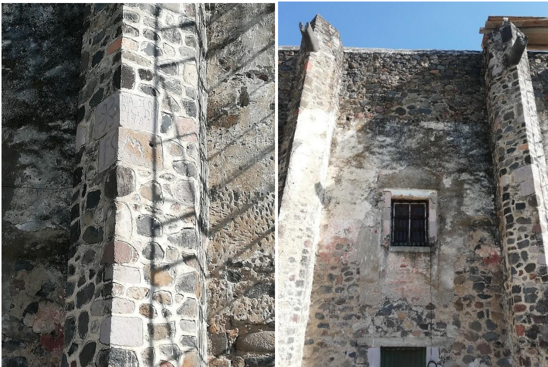
Imagen 119. Detalle del contrafuerte reconstruido con material reutilizado en el siglo XX. Fotografía: Leticia Domínguez, 2020.
