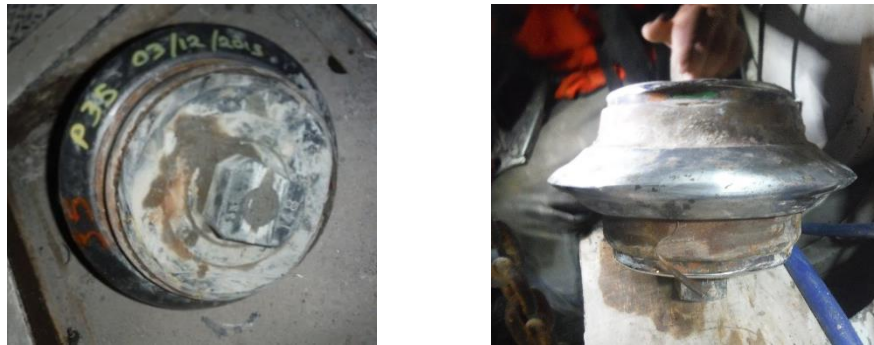
Figura 5.8 Desgaste primario excesivo. TEO, Tramo IV
