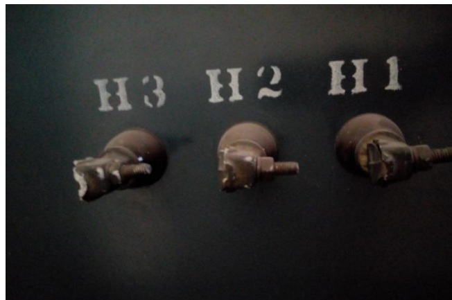
1.2 Transformador trifásico, terminales de alta tensión, conexión delta.
