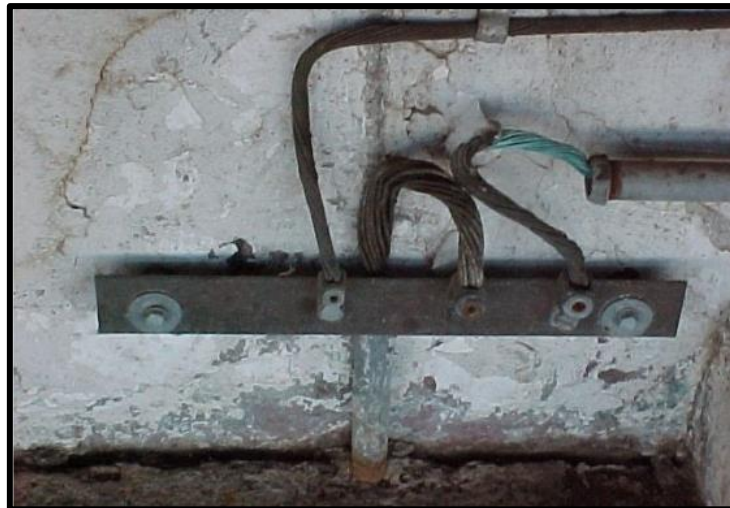
2.4 Barra de puesta a tierra en mal estado por falta de mantenimiento.
