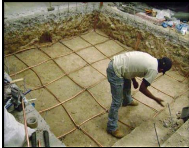
2.1 Malla de puesta a tierra
