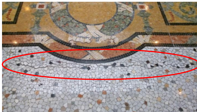
GRIETA P. Ubicada cerca del centro del Salón de recepciones, presenta segmentos de grieta con abertura de 2.3 a 3 mm y con profundidades de 2 mm.
