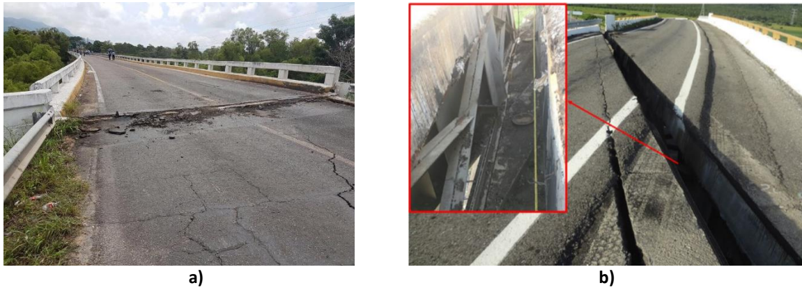
Figura 44. Puentes que sufrieron un tipo de daño; a) Puente “La Cintel”, Carretera Ocozocoautla – Cintalapa, Chiapas., b) Puente “La Ventosa” ubicado carretera Salina Cruz-La Ventosa, Oaxaca.
