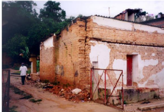
Figura 11. Daño en edificación de adobe sin cerramiento entre muros ortogonales ocasionado por el sismo del 30 de septiembre de 1999, San Gabriel Mixtepec, Oaxaca.
