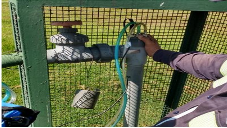
Ilustración 3.1.3. Explosímetro conectado a un pozo de Biogás para su monitoreo.
