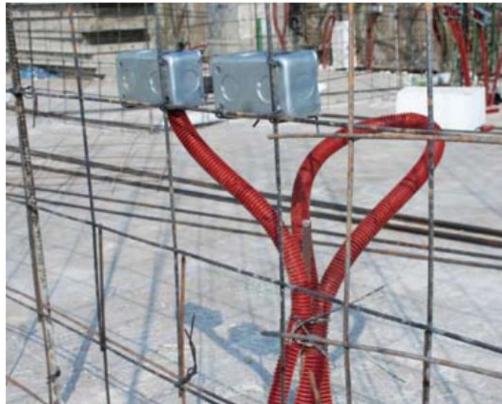
Figura 5 Bloqueos temporales en conexiones eléctricas
