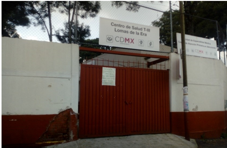
Imagen 5 Imagen del acceso del centro de Salud Lomas de la Era, dañado en el sismo del 19 septiembre del 2017.
