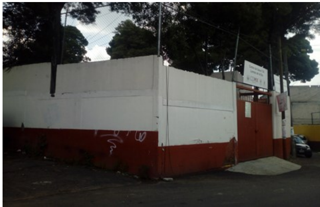
Imagen 17. Imagen del acceso del centro de Salud Lomas de la Era, dañado en el sismo del 19 septiembre del 2017.
