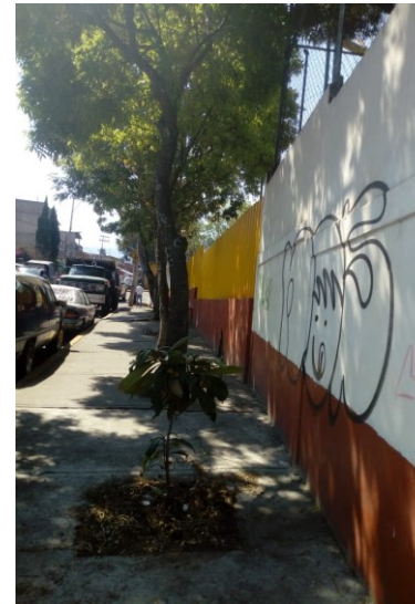
Imagen 6. Daño en equipamiento público e infraestructura peatonal.
