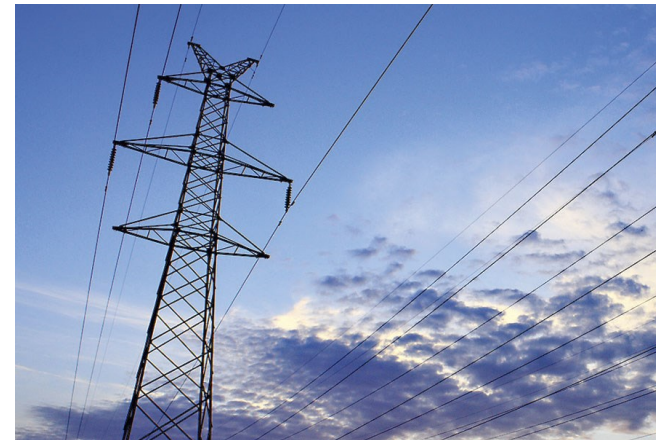
Imagen 86. Imagen de Torres eléctricas.
