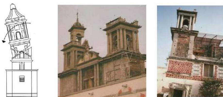
Figura 2.26- Mecanismo de falla típico de un campanario bajo los efectos de un sismo y daños observados en Colima tras un sismo. (Meli R., 1998)
