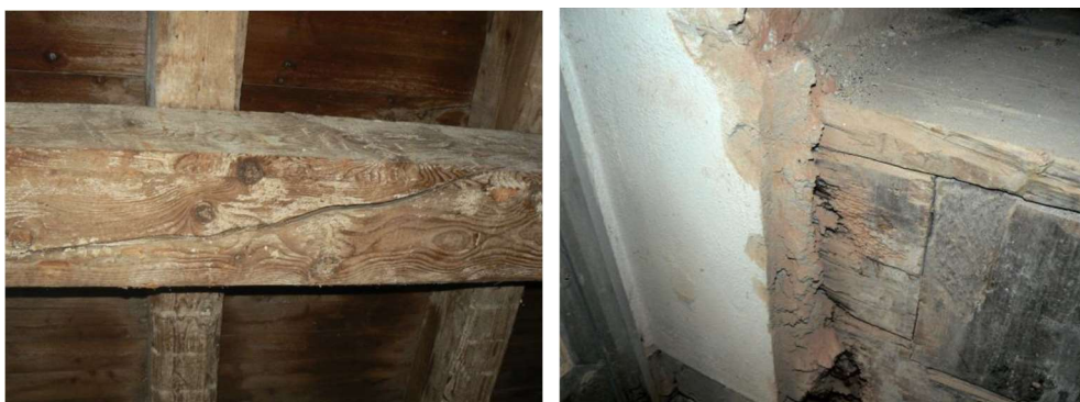
Figura 2.22- Daños en una estructura de madera debido al cambio de humedad dentro de un edificio histórico en la República Checa. (a) Grieta de contracción; (b) Deterioración del material (Hermankova V. et al, 2018).
