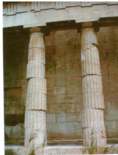
Figura 2.11- Daño en columna de bloques (Meli R., 1998).
