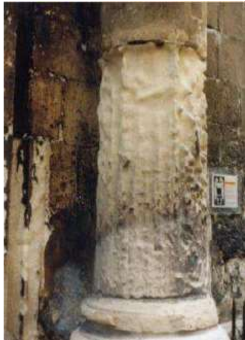
Figura 2.8- Degradación de una columna por los efectos ambientales (Peña y Lourenco, 2012).
