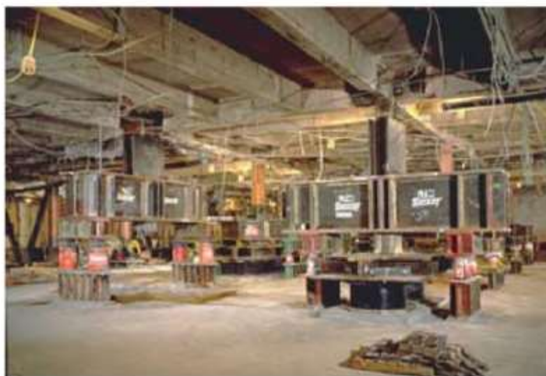
Figura 5.25– Instalación de aisladores bajo las columnas del edificio del ayuntamiento de San Francisco (Iskhakov y Ribakov, 2006).
