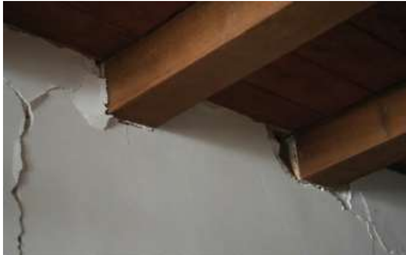
Figura 2.1- Agrietamientos verticales en muros producidos por la concentración de esfuerzos a causa del aislamiento de los apoyos del sistema de piso (Marini A., 2015).
