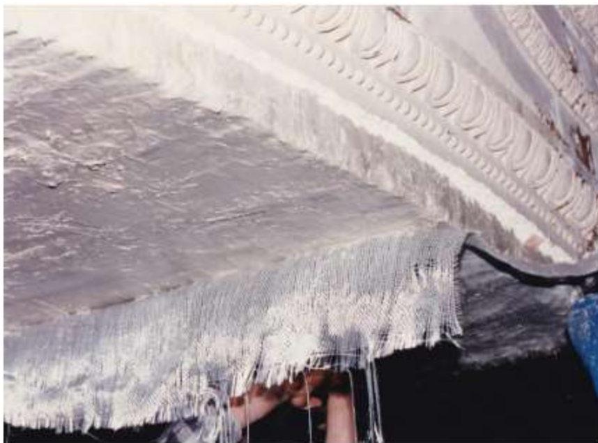
Figura 5.16- Aplicación de banda de GFRP al intradós de un arco (Grazzini A., Agnetti S., 2019).
