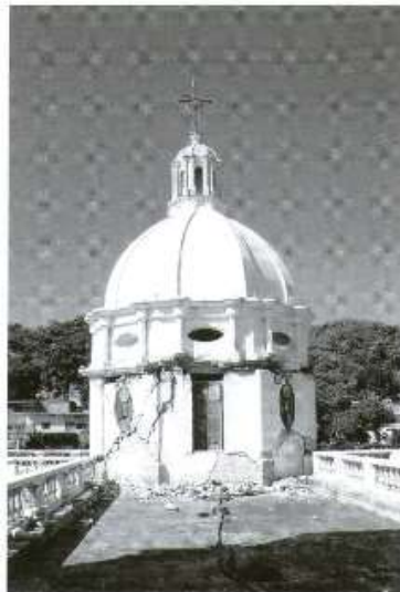
Figura 2.12- Daños en cúpula debido a sismo. (Meli R., 1998).
