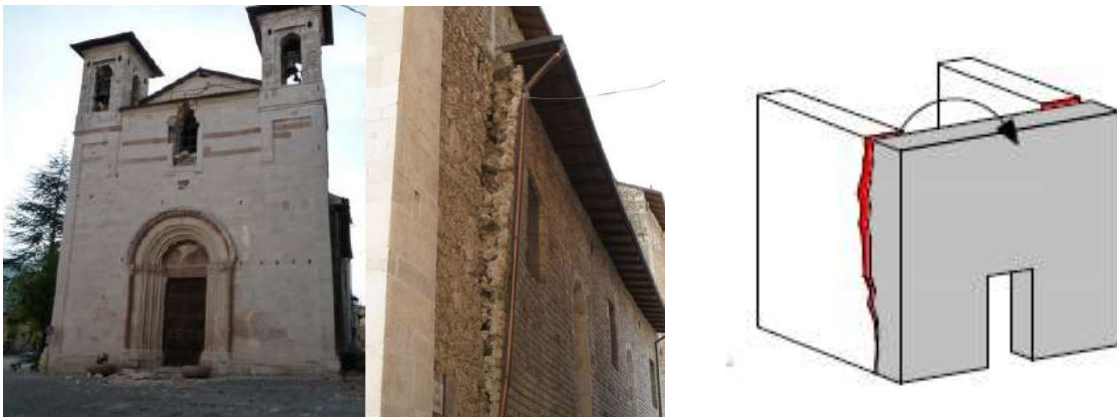
Figura 2. 4- Desprendimiento de la fachada del resto del edificio. (Marini A., 2015).
