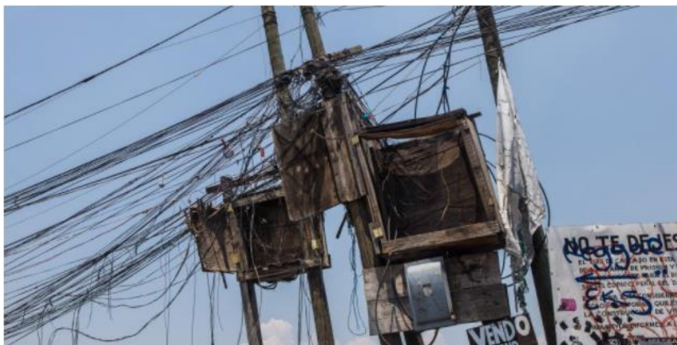
Ilustración 6. Muestra de una toma clandestina de luz eléctrica que se replica en zonas de bajos recursos económicos como San Miguel Xico en el Estado de México
