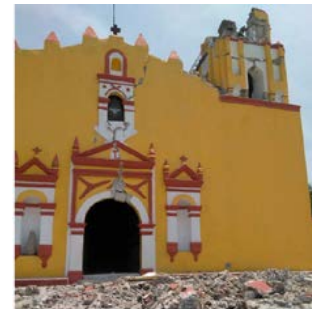
Iglesia San Felipe Apostol después del sismo del 2017.
