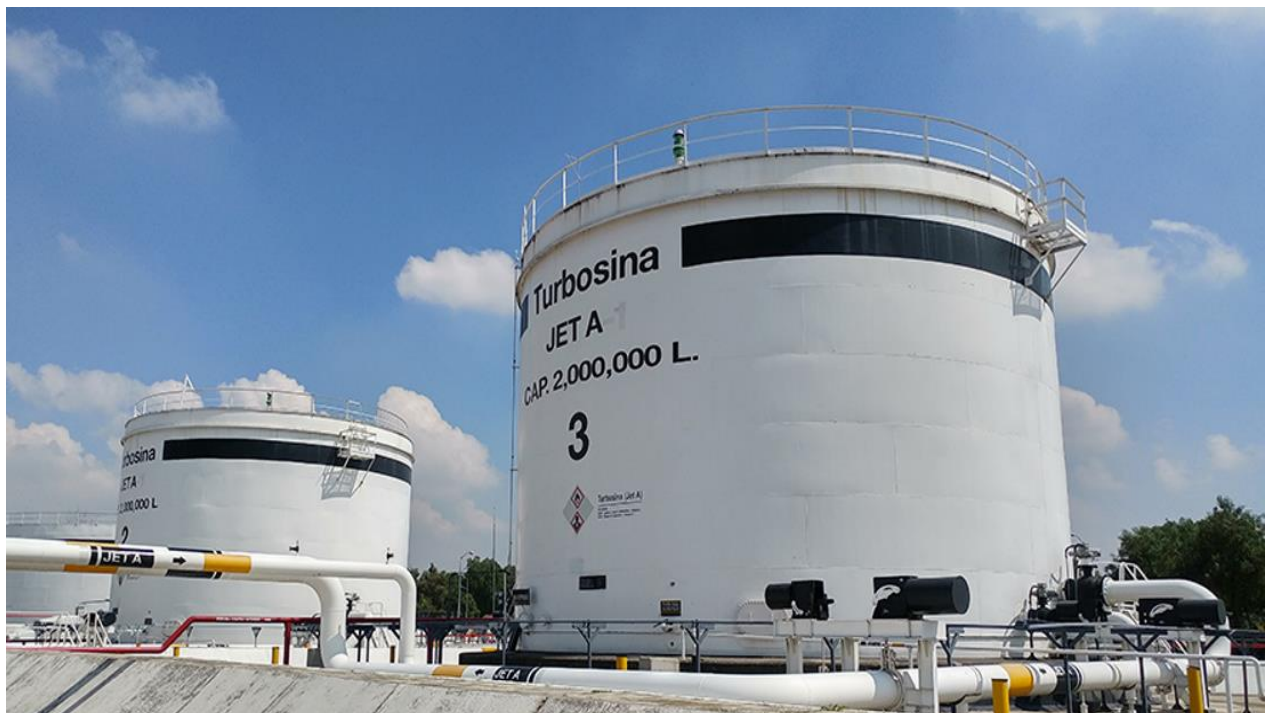
Figura 4.15 Tanque de almacenamiento vertical. (ASA, 2019).
