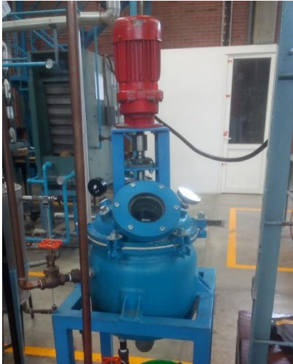
Figura 21. Digestor Instalado en la Nave 1000 de I.Q.
