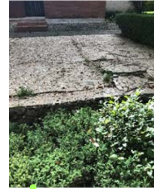
Imagen 31 Superficie en mal estado. Fotografía propia (2020)
