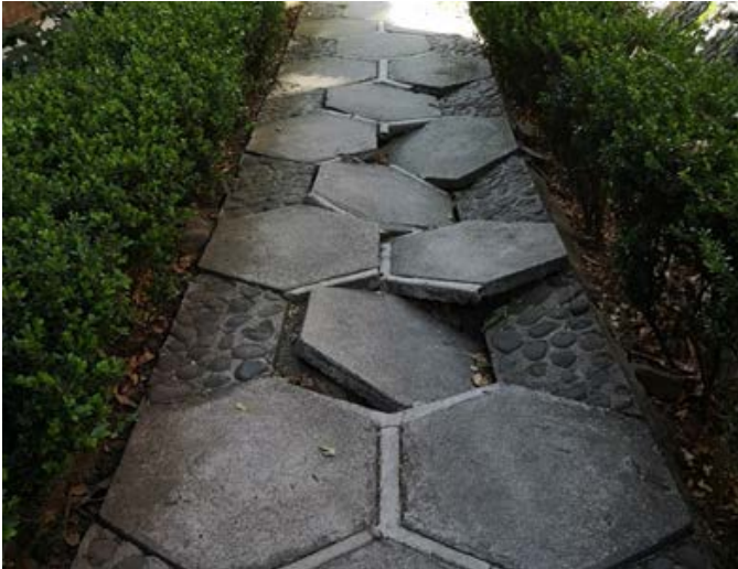
IMAGEN 20 Superficie en mal estado. Fotografía propia (2020)
