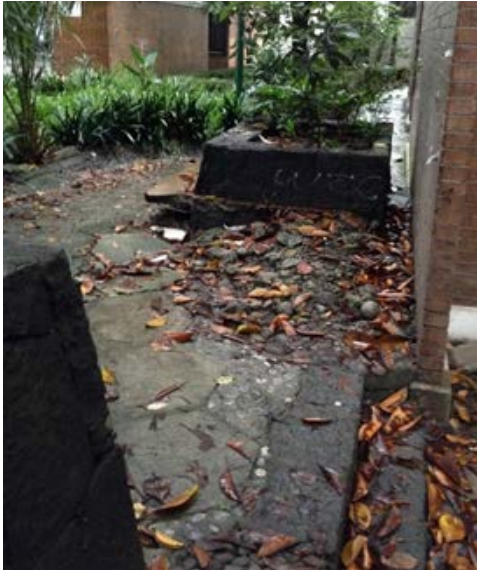
Imagen 36 Superficie en mal estado. Fotografía propia (2020).
