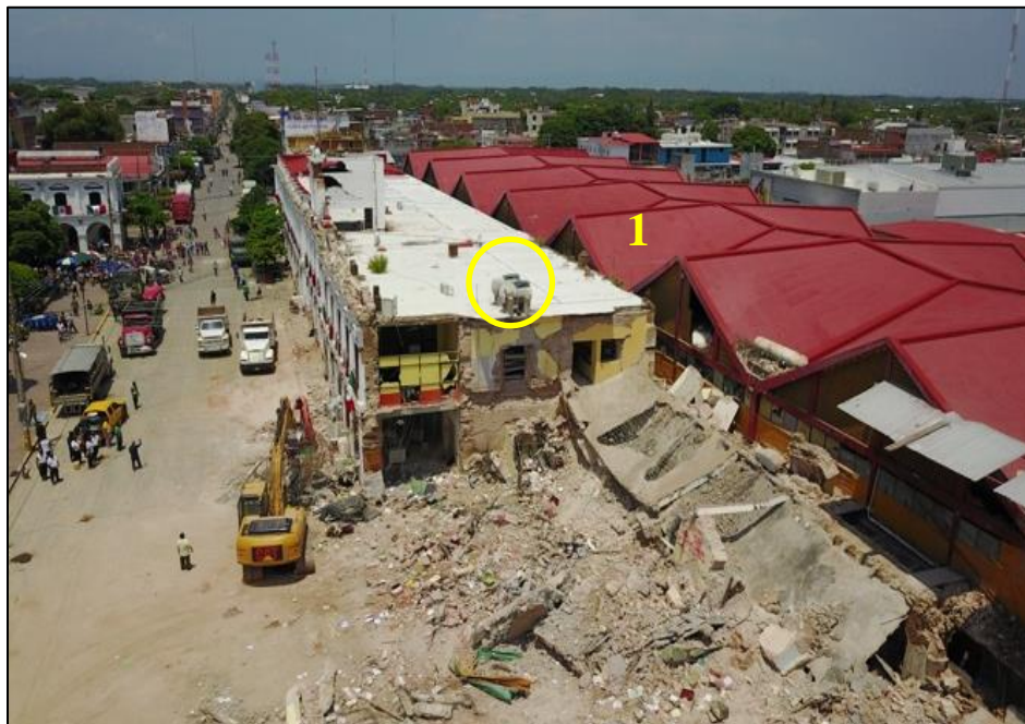
Figura 3- 22 Daños en el palacio municipal de Juchitán, Oaxaca. Se observan dos tanques de gas en la orilla de la estructura sin colapso (1). Escombros de la fachada caída en la marquesina, que pudieran caer en el caso de una réplica.
