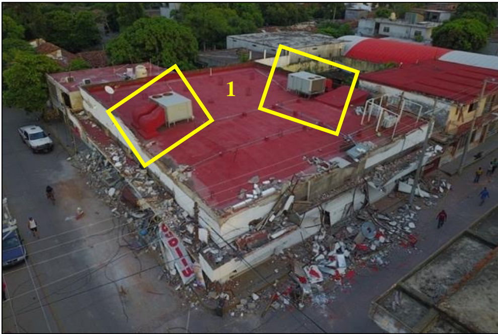
Figura 3- 24 Imagen aérea de un edificio colapsado en Juchitán, Oaxaca. Podemos observar carga muerta en la azotea (1) y se descarta la existencia de tanques de gas LP en el mismo y en su vecindad.
