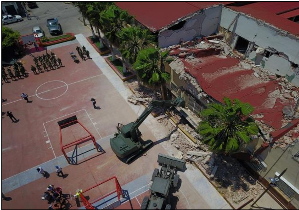
Figura 3- 28 Centro Escolar, Juchitán, Oaxaca, 10/09/2017, presenta daños estructurales a causa del sismo del 7 de septiembre de 2017, queda inhabilitado para su uso hasta su rehabilitación.
