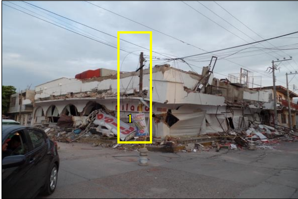
Figura 3- 23 Fotografía a nivel de piso de un edificio colapsado en Juchitán, Oaxaca. Sólo podemos visualizar el riesgo que representan los cables de distribución eléctrica (1).
