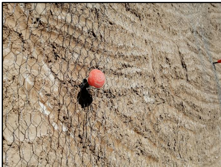
Fig. 28. Soporte para la malla de protección.
