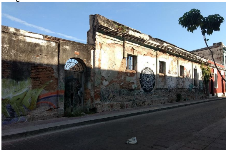
Figura 5.12. Inmueble deteriorado en el Centro Histórico
