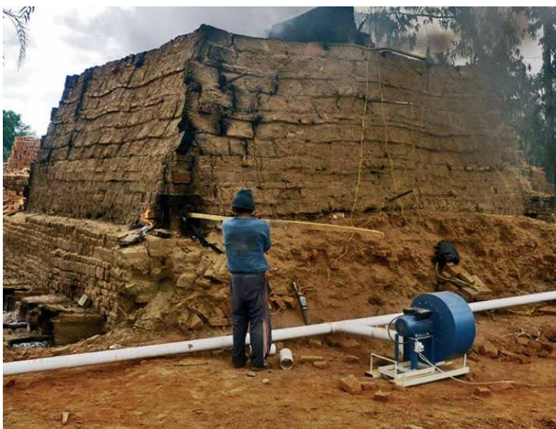
Figura 28: Ventilador en horno ladrillero Fuente: Roque, 2014
